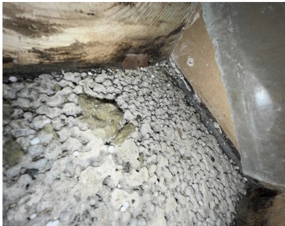
Kuva 47 US1. Höyrynsulku ei limity.
