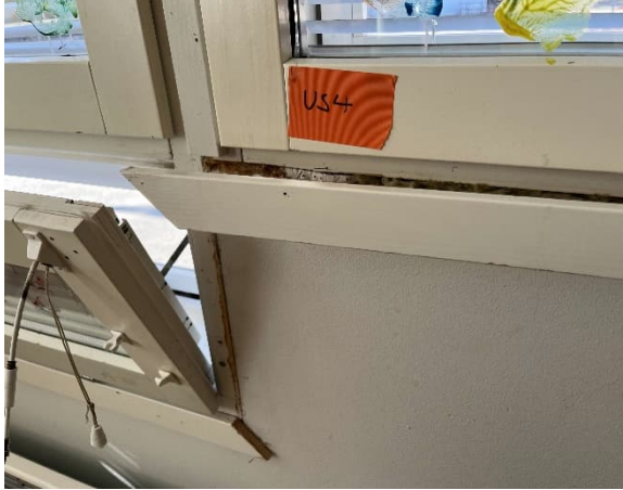
Kuva 55 US4. Ikkunan liittymä oli melko avonainen.
