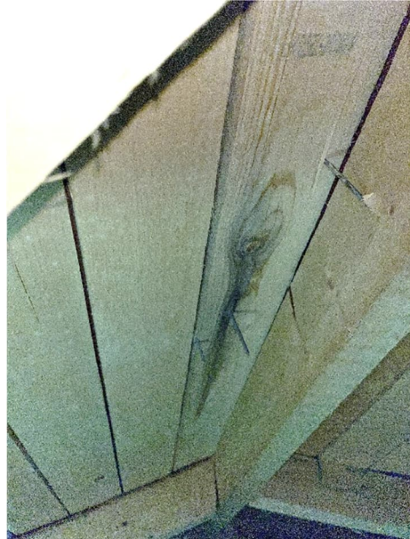
Kuva 121. Vauriojälkiä naulojen läpivientien alueella. Irtovesi pääsee yläpohjaan naulanreikien kautta.
