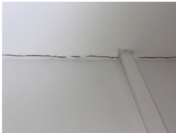
Kuva 137 Seinä-kattoliittymissä havaittiin elämisen jälkiä. Valtaosa liittymistä oli tiivistetty umpeen.
