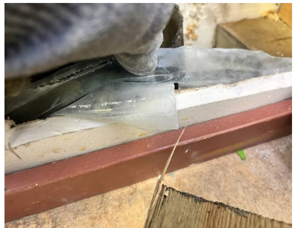
Kuva 70 US6. Höyrynsulkumuovi ei limity.
