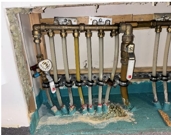
Kuva 102 VS7, Jakotukkia kylmiön vastaisen väliseinän aukossa. Jakotukissa pienimuotoinen tiputusvuoto. Kaukalon toteutus puutteellinen.
