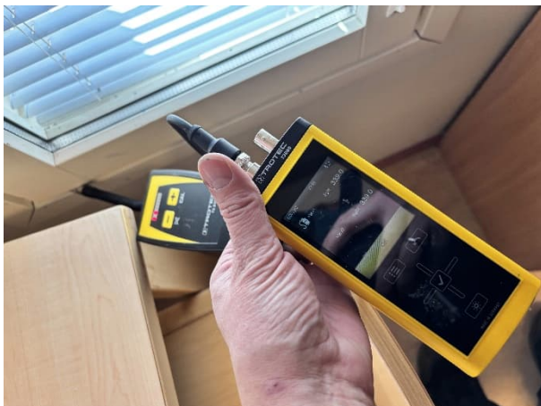
Kuva 131 Ulkoseinä-ikkunaliittymien kautta havaittiin laaja-alaista ja merkittävää ilmavuotoa.
