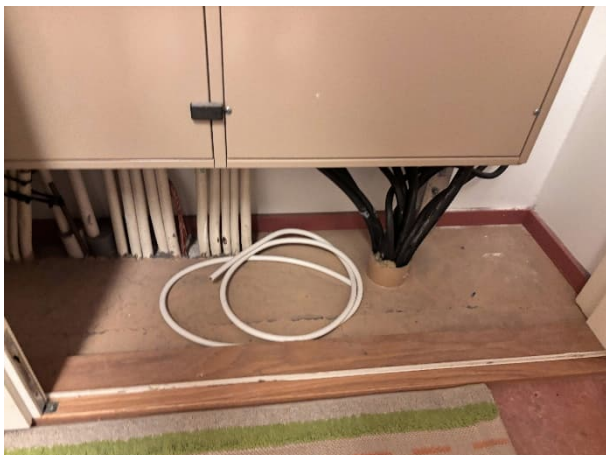
Kuva 136 Sähkökeskuksen läpiviennit epätiivaitä.
