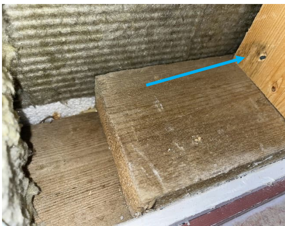
Kuva 53 US3. Ulkoseinärakennetta. Lievää kosteusjälkeä nuolen
