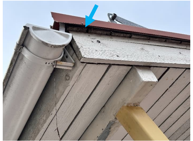
Kuva 125. Räystäään alimmissa laudoissa havaittiin vauriojälkiä.
