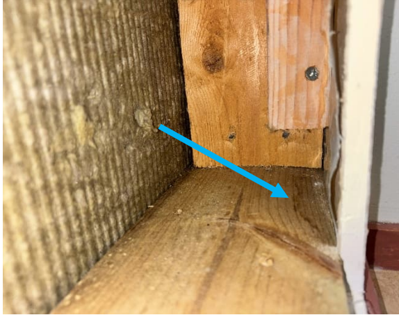
Kuva 61 US5. Yksittäinen vanha kosteusjälki alaojhauspuiden yläpinnalla.
