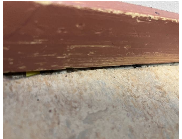
Kuva 48 US2. Ulkoseinän eristetilaan on ilmayhteys listan alta.
