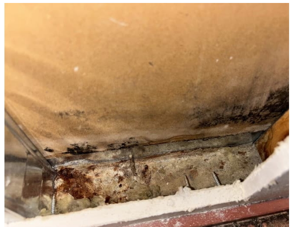
Kuva 95 VS2, keittiön vastaista väliseiniää, mikrobivaurio todettu.
