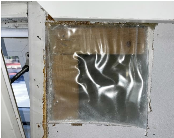
Kuva 57 US4. Höyrinsulku liittyy ikkunan karmeihin epätiivisti.
