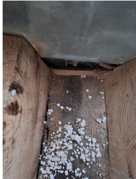
Kuva 85 US13. Höyrynsulku ei limity.
