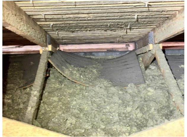
Kuva 117. Tuulenojaimet ovat osittain irti.
