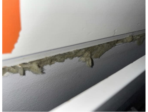
Kuva 56 US4. Listan alta näkyy ikkunan tilkemineraalivillaa.
