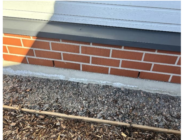
Kuva 12 Sokkelissa oli paikoin kalkkihärmää.
