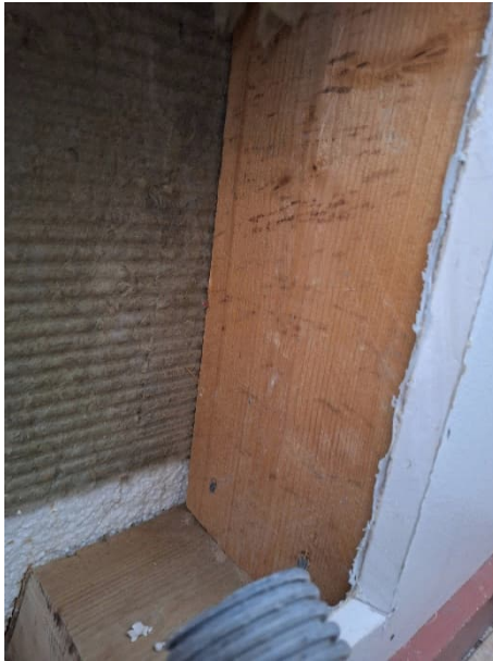
Kuva 84 US13. Pystyvuussa roiskejälkiä, arviolta peräisin rakennusajalta.
