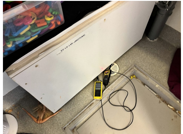
Kuva 128 Pistemäistä ilmvuotoa sisäilmaan havaittiin jakotukin kautta.
