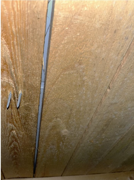
Kuva 120. Vauriojälkiä naulojen läpivientien alueella. Irtovesi pääsee yläpohjaan naulanreikien kautta.
