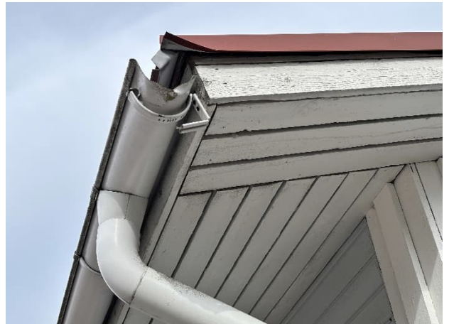
Kuva 123. Räystäskourusta puuttuu päätykappale.
