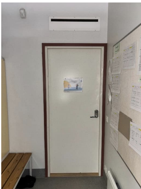
Kuva 138 Siirtoilmaventtiili suodattimet ovat likaisia.
