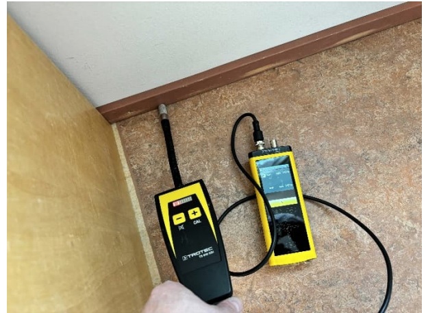
Kuva 130 Ulkoseinä-lattialiittymien kautta havaittiin laaja-alaista ja merkittävää ilmavuotoa.
