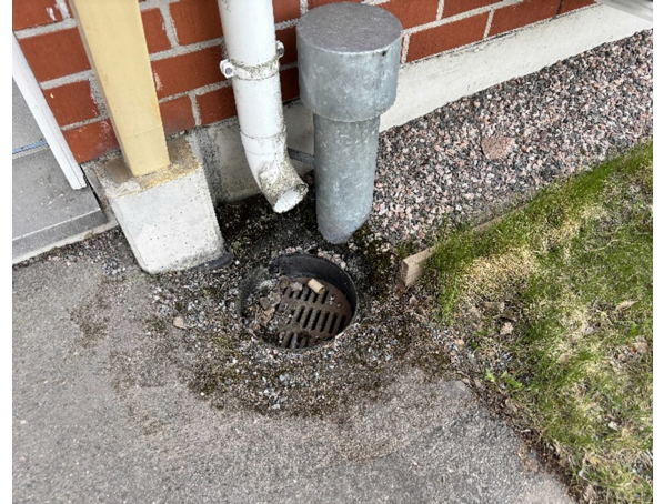
Kuva 18 Teknisen tilan edessä sadevedet ohjautuvat paikoin sadevesikaivon ohi.
