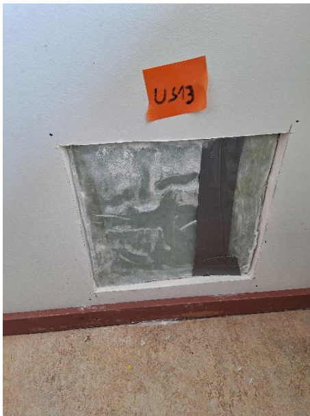
Kuva 82 US13. Höyrynsulkua teipattu ilmastointiteipillä.
