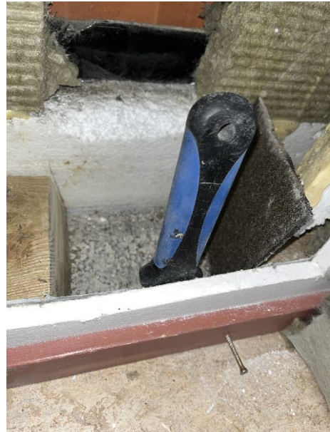
Kuva 46 US 1. Kevytbetoniharkon ja alapohjalaatan välissä on rako.
