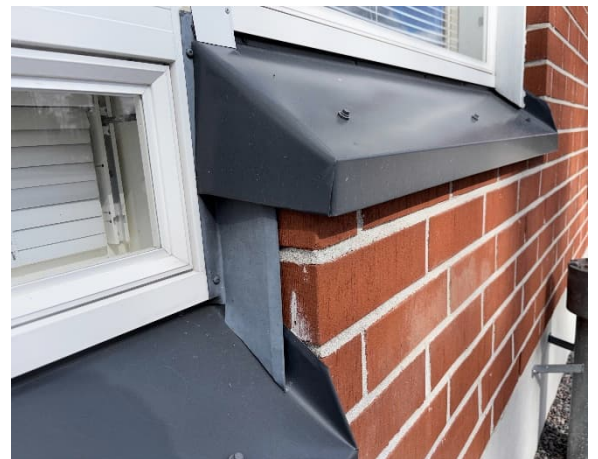
Kuva 37 Ikkunapellitys on arviolta uusittu hiljattain. Osa pellitysten osista arviolta alkuperäisiä.
