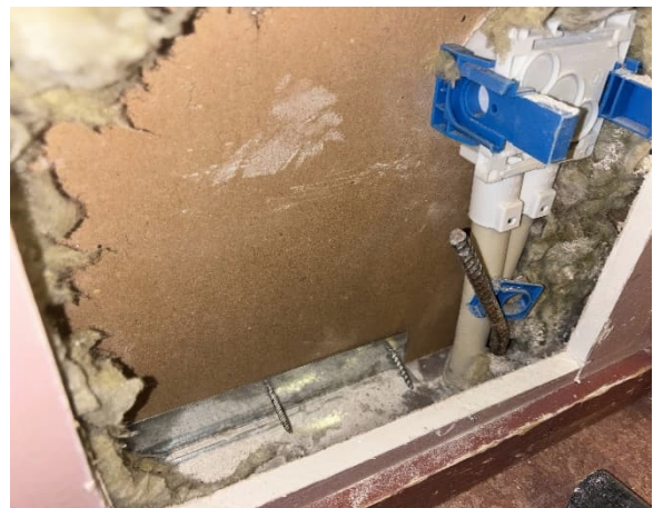
Kuva 99 VS4. Siivouskomeron vastaista väliseinää. Väliseinän takana lämminvesivaraaja.
