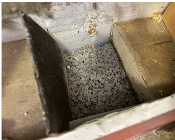
Kuva 69 US6. Bitumikermin alla kevytsoraharkko.
