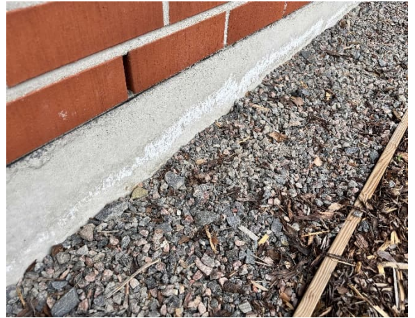
Kuva 42 Sokkelissa havaittiin kalkkihärmää.
