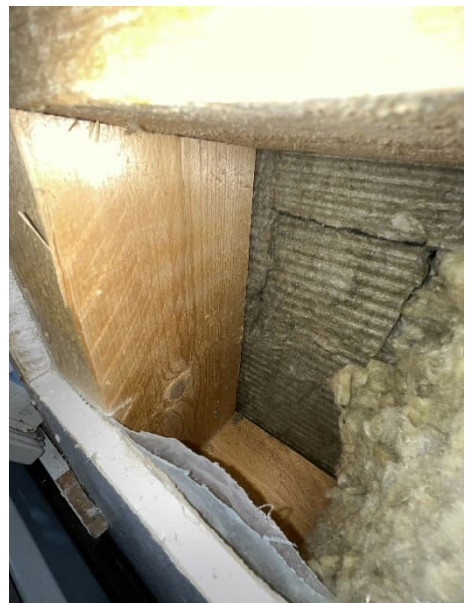
Kuva 60 US4. Avauksessa ei havaittu
