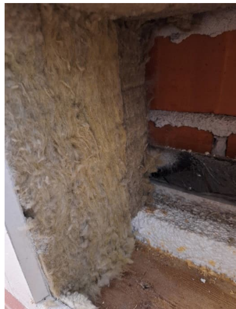
Kuva 75 US10. Mineraalivillassa ei havaittu tummentumaa.
