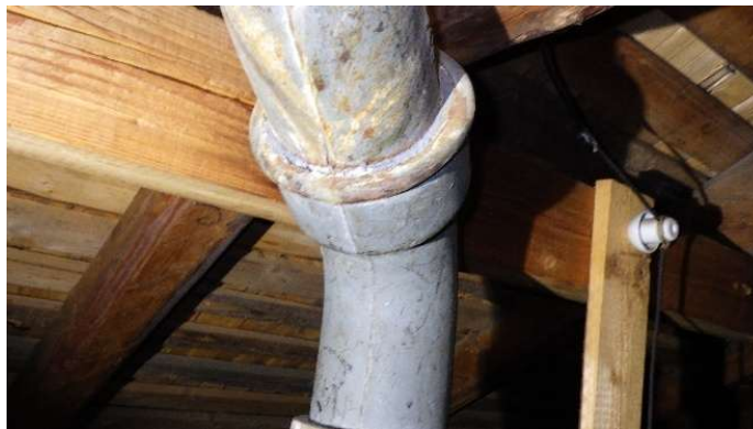
Kuva 41. Vanha eristämätön viemärin tuuletusputki.
