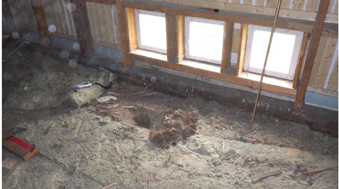
Kuva 24. Ullakon ikkunat ovat huonokuntoisia.
