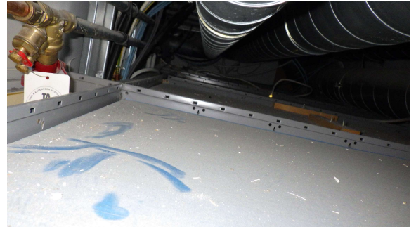
Kuva 36b. 2. kerroksen alaslaskun yläpuolella oli runsaasti tekniikkaa ja pölyä (AL5).
