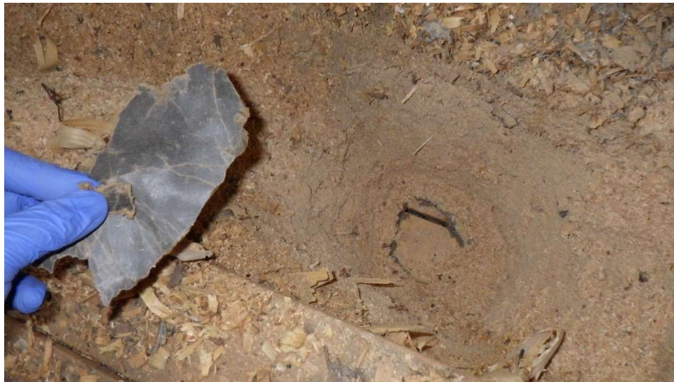
Kuva 47. Rakenneavauksessa 12 eristetilan pohjalla olevassa tervapaperissa havaittiin epäily mikrobikasvusta. Sahanpurussa havaittiin selvä mikrobikasvu.
