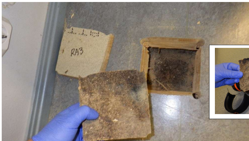
Kuva 10a-b. Rakenneavaus RA3 tilassa 105. Lattialevyn ja vanhan lattialankun välissä oleva pahvi on vaurioitunut / tummunut ja siinä havaittiin epäily mikrobikasvusta.
