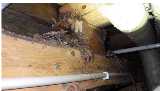
Kuva 34a. Turvetta ja avointa mineraalivillaa musiikkiluokan 120 varaston (AL2) alaslasketun katon yläpuolella .
