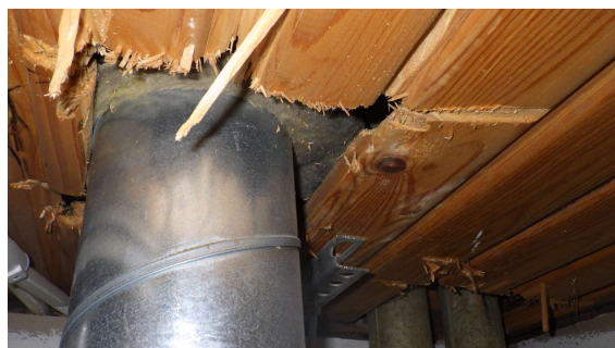
Kuva 33b. Epätiivis läpivienti yläpohjaan (AL1).
