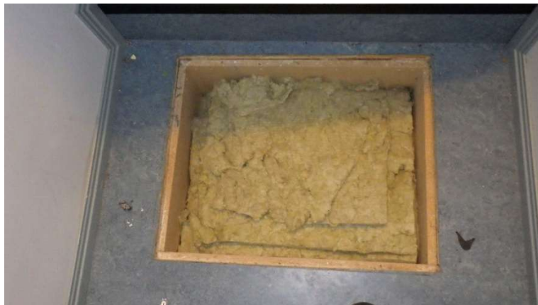
Kuva 7. Lattialuukku luokan 120 yhteydessä olevan näyttämön portaikossa. Vastaavanlainen luukku on luokan 120 varaston yhteydessä. Varastossa aistittiin mikrobiperäistä hajua. Luukut on suositeltavaa tiivistää.
