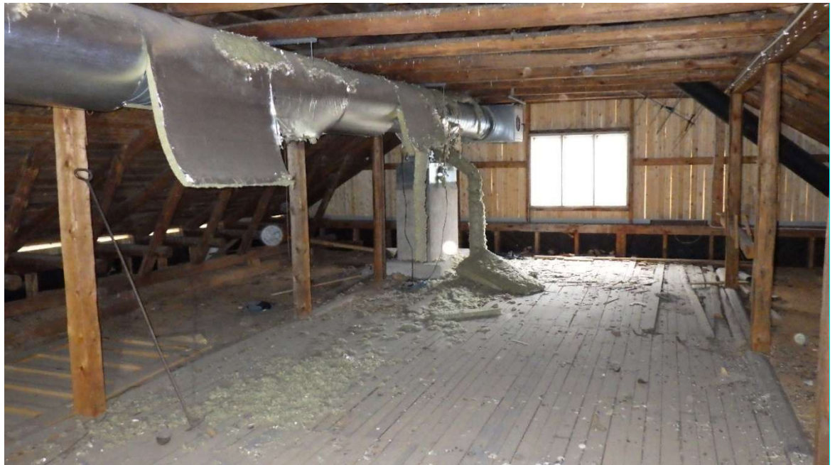
Kuva 42. Yläpohjatilán tuuletus toimii aistivaraísen arvion perusteella hyvin. Todennäköisesti linnut ovat rikkoneet IV-kanavan eristysksiä.
