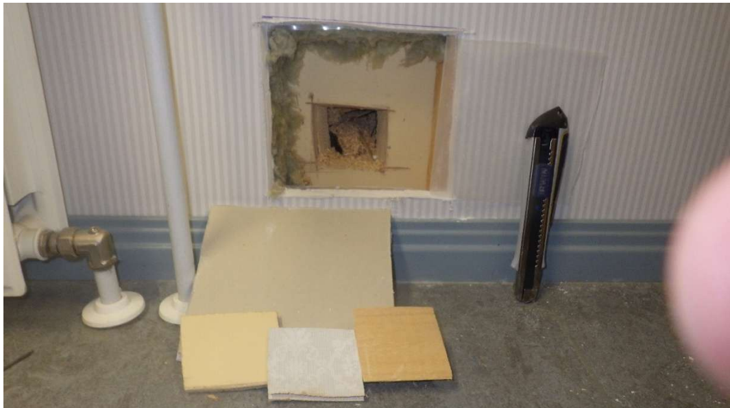
Kuva 27. Esimerkkikuva purueristeisen ulkoseinän rakenneavauksesta (tila 215, RA20). Vain pieni osa seinistä on purueristeisiä ja suurin osa seinistä on hirsirunkoisia.
