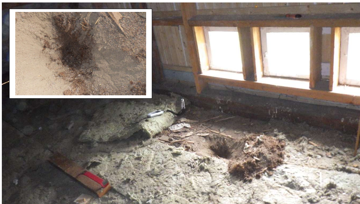
Kuva 45a-b. Rakenneavaus 7. Eristetilan pinnassa oleva mineraalivilla on mikrobivaurioitunut.
