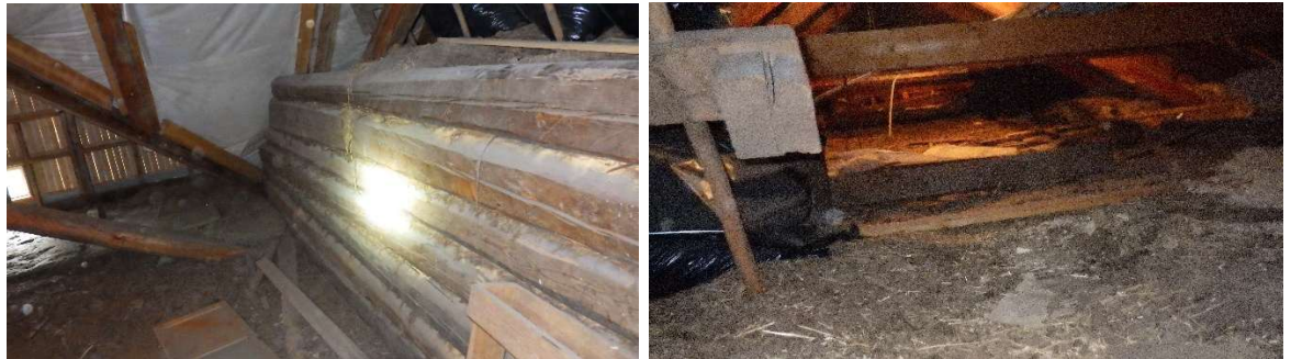
Kuva 46a-b. Rakenneavauksen 8 kohdalla eristetila on noin 1,5 m korkeammalla kuin rakenneavauksen RA7 kohdalla. Turpeessa havaittiin selvä mikrobikasvu.
