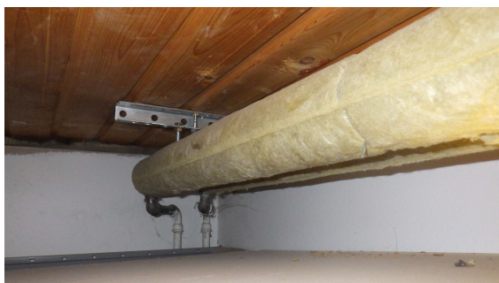
Kuva 33a. Avointa mineraalivillaa ja roskaa alaslasketun katon AL1 yläpuolella .
