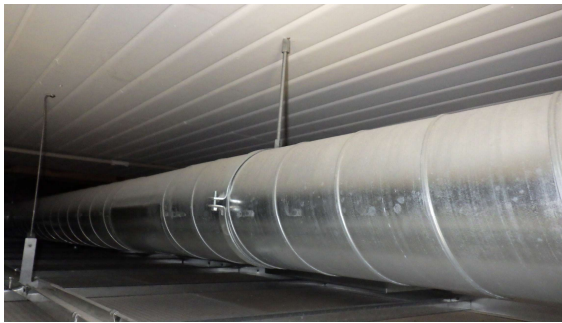
Kuva 36a. Pölyä käytävän 202 alaslaskun yläpuolella (AL4).
