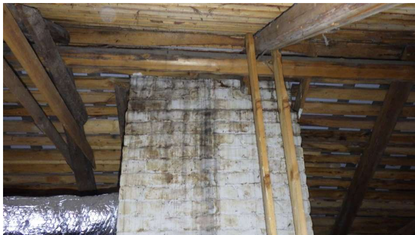
Kuva 31. Paikoittain hormien kyljissä havaitut kosteusjäljet ovat todennäköisesti peräisin vesikatteen uusimista edeltävältä ajalta.
