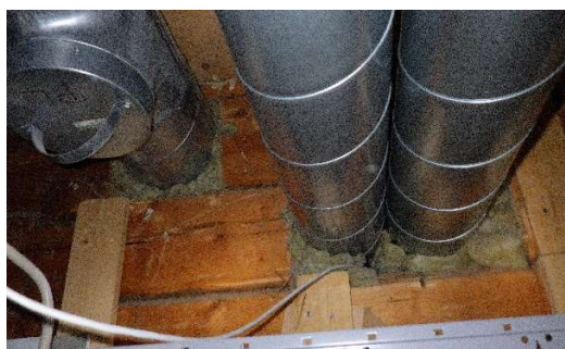
Kuva 27b. Epätiivittä läpivientejä ja avointa mineraalivillaa (AL2).
