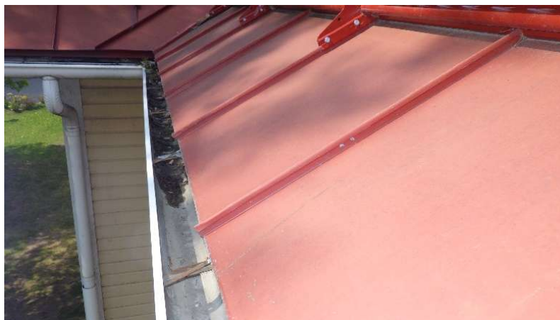
Kuva 38. Sadevesikouruissa havaittiin tarkastushetkellä paikoin roskia.
