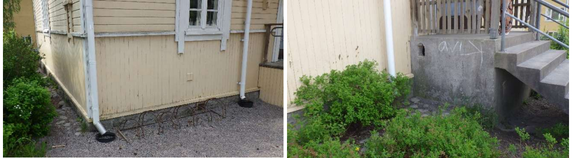
Kuva 3a-b. Rakennuksen päätyihin sokkelin juureen on asennettu luonnonkiveys. Kasvillisuus on rakennuksen päädyissä paikoin liian lähellä rakennuksen ulkoseiniä.
