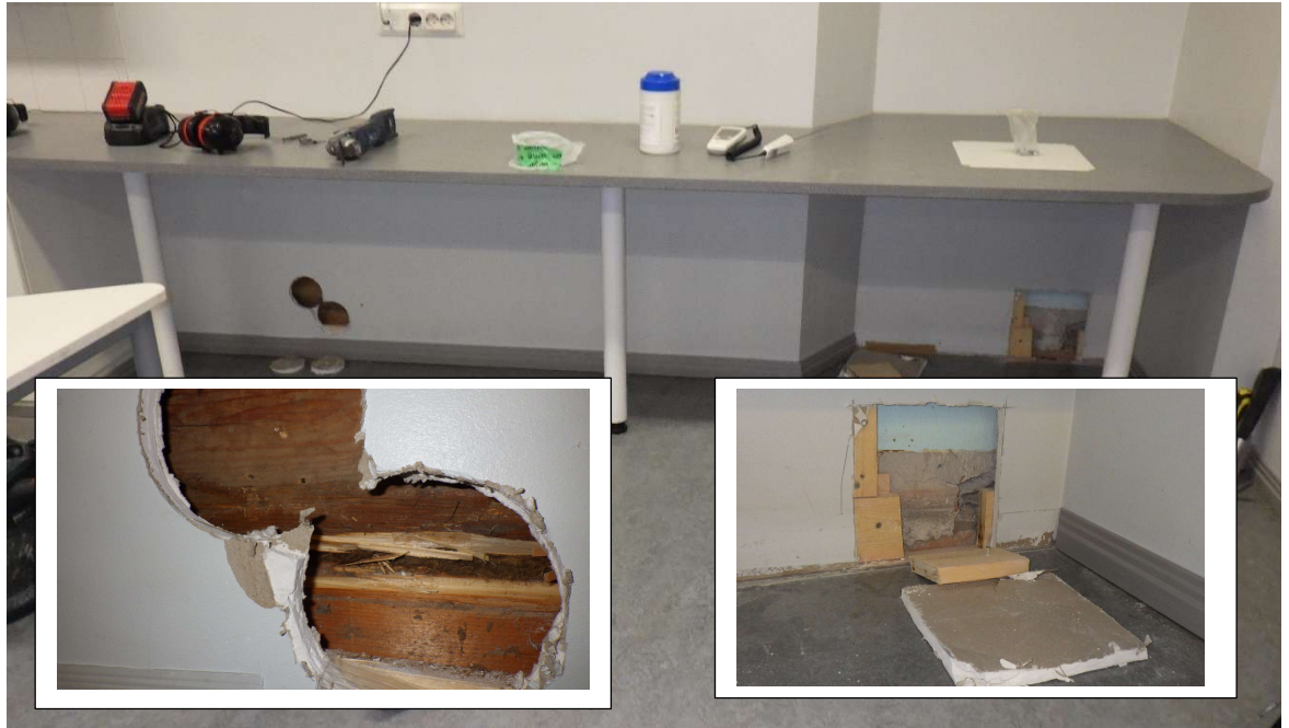
Kuva 24a-c. Tilan 06 väliseinän rakenneavaukset (RA16 ja RA17). RA16 on hormin kohdalla ja RA17 hirsirakenteen kohdalla.
