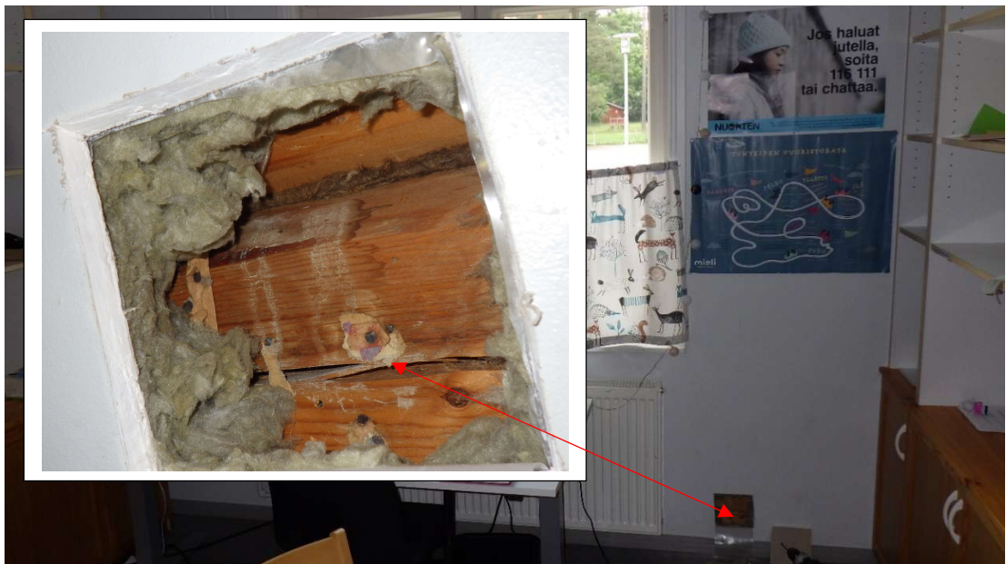
Kuva 20. Tilan 17 ulkoseinän rakenneavauksessa (RA12) havaittiin lieviä kosteusvauriojälkiä. Rakenteesta kerätyissä materiaalinäytteissä ei havaittu kuitenkaan mikrobikasvua.
