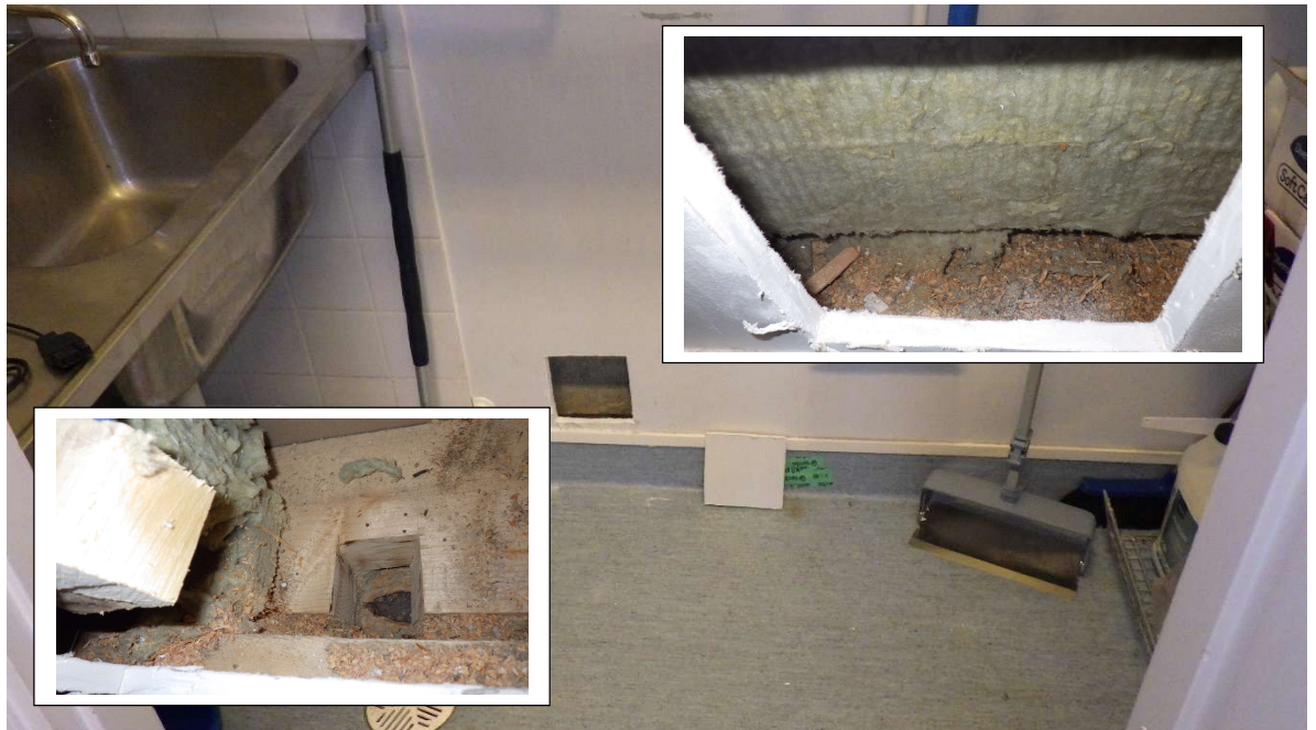
Kuva 23a-c. Tilan 18 väliseinän rakenneavaus (RA15). Mineraalivillassa havaittiin epäily mikrobikasvusta.
