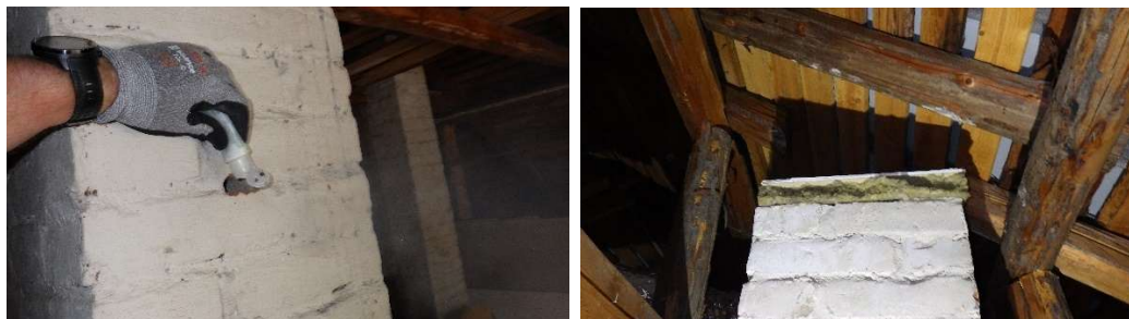
Kuva 32a-b. Yksittäisen hormin kyljessä havaittiin reikä, josta virtaa ilmanvaihdon poistoilmaa yläpohjatilaan. Osa kivirakenteisista hormoneista on katkaistu ja poistettu käytöstä (kuva oikealla).
