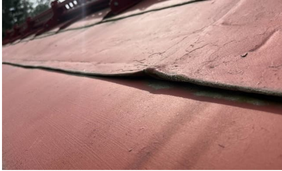
Kuva 64. Peltikatteen saumauksissa havaittiin puutteita. Irtovesi ja lumi pääsee rakenteisiin epätiiveyksien kautta.
