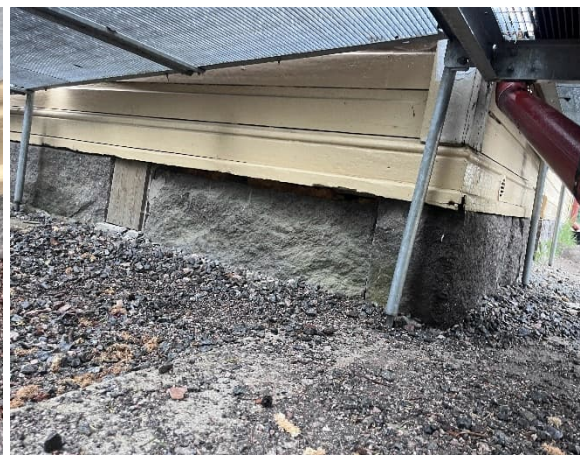
Kuva 35. Lännen puoleisella sivulla puuverhoilussa havaittiin paikoin lahoa.
