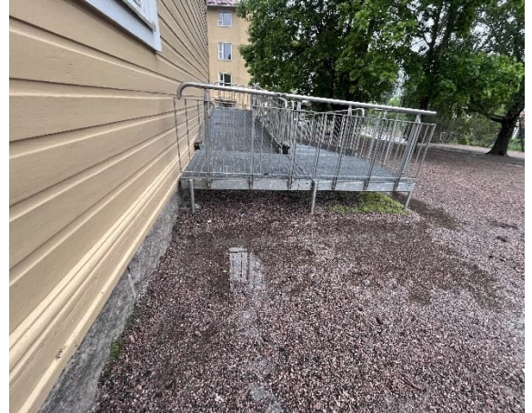
Kuva 10 Vesi lammikoituu paikoin rakennuksen vierustalle.
