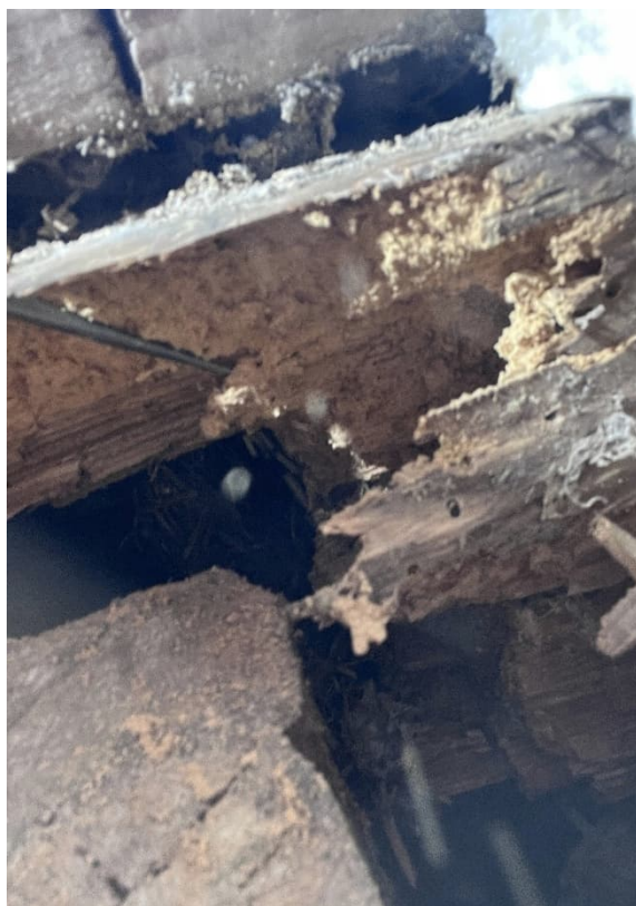
Kuva 36. Ulkoseinän alimmissa hirsissä todettiin laajoja lahovaurioita rakennuksen pohjoispuolella.
