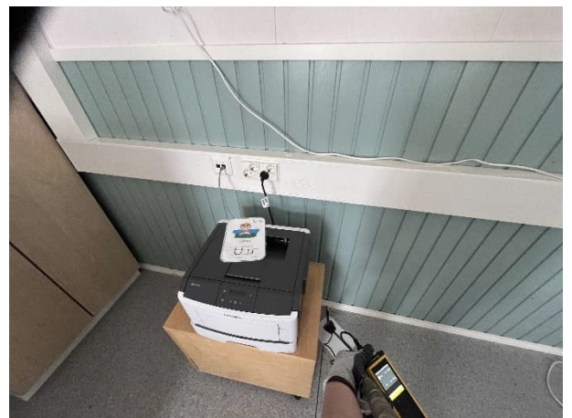
Kuva 68 Ryömintätilan kautta havaittiin ilmavuotoa sisäilmaan.
