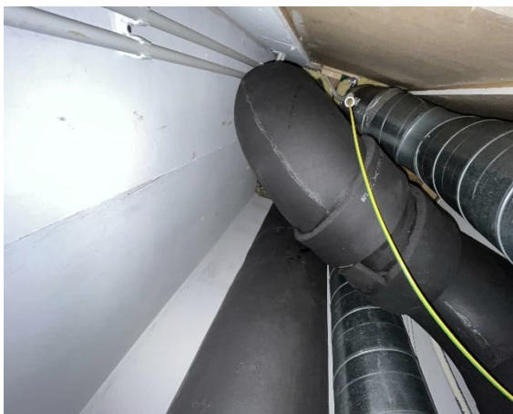
Kuva 81 IV-kanavien läpiviennissä havaittiin avoimia kuitupintoja.
