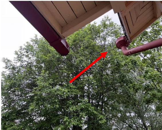
Kuva 11 Sadevedet ohjautuvat rännisuppilon ohi.
