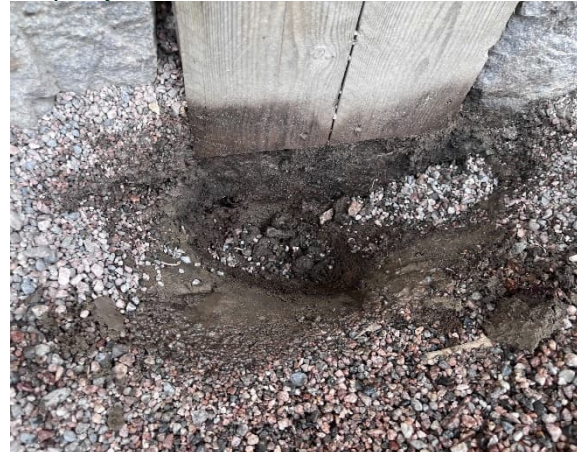
Kuva 19. Maaperä oli savista ja märkää rakennuksen pohjoispuolella, ryömintätilan luukun alueella.
