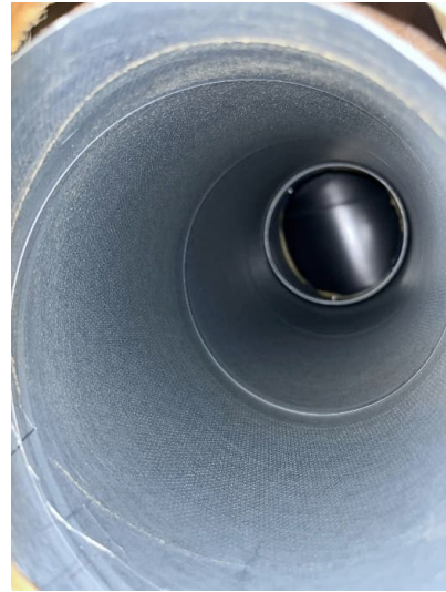
Kuva 78 Tuloilmakanavaa tilassa 05. IV-kanavassa havaittiin aistinvaraisesti arvioituna jonkin verran siitepölyä.
