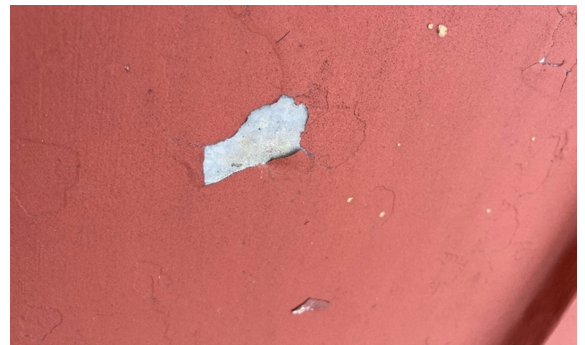
Kuva 59 Peltikatteen maalipinnoite irtoilee.
