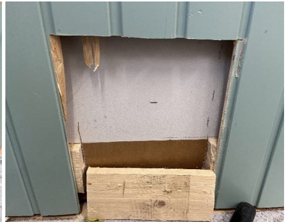
Kuva 45. VS2 tehtiin tilaan 06.
