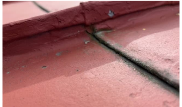
Kuva 61. Peltikatteen kiinnityksessä havaittiin puutteita.
