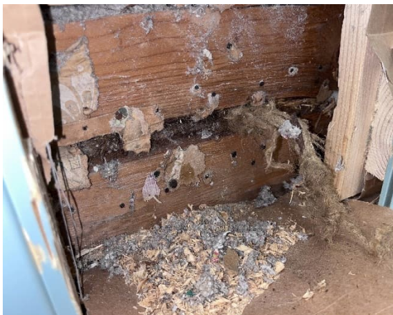
Kuva 50. VS3 tehtiin tilaan 05.
