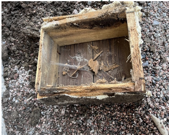
Kuva 20 Luukussa havaittiin lahovaurioita.
