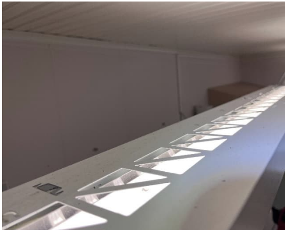
Kuva 79 Luokkatilassa yläpölyjä havaittiin jonkin verran.
