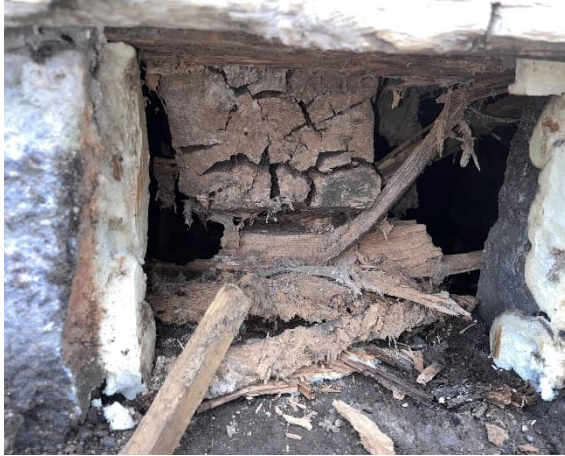
Kuva 22 Ryömintätilaa, pohjoispuoli. Lattiakannake on tippunut.
