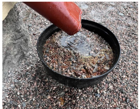
Kuva 8 Rännikaivot soraa täynnä.
