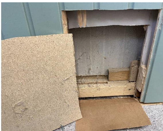
Kuva 46. VS2. Rakenteessa havaittiin useita sisäverhouksia.
