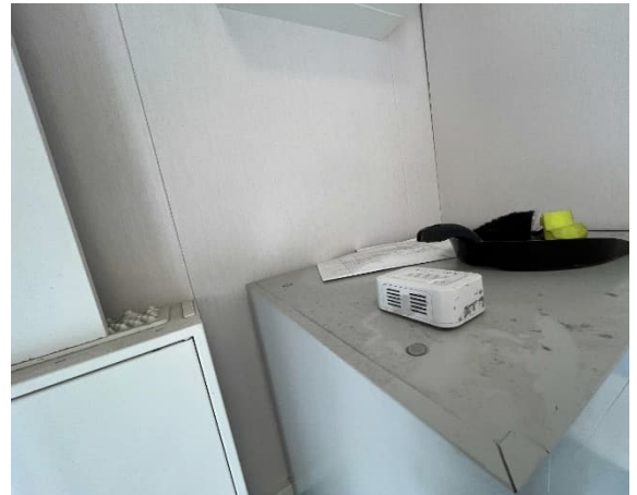
Kuva 80 Eteisen alueella yläpölyjä havaittiin runsaasti.
