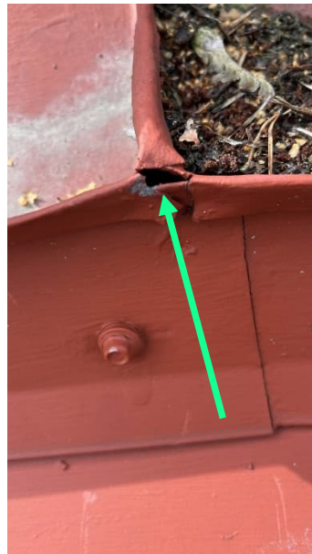
Kuva 63 Peltikatteessa havaittiin epätiiveyksiä.
