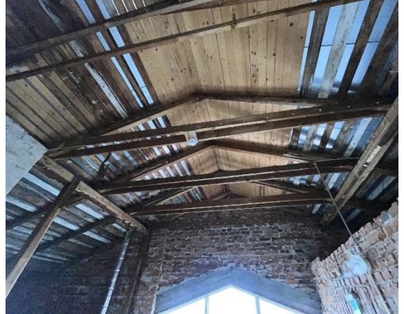
Kuva 136 Korkean osan yläpohjaa. Harjan umpilaudoitus on uusittu paikoin.
