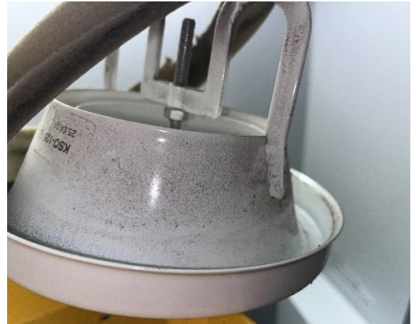
Kuva 191 Poistoilman päätelaite tilassa 317, WC-tytöt.
