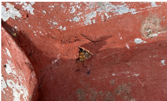
Kuva 117 Reikä vesikatteessa, rakennuksen korkea osa.
