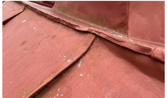
Kuva 126 Peltikatteen saumauksissa havaittiin paikoin puutteita.
