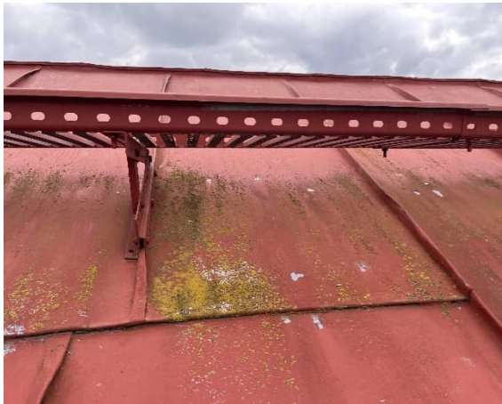
Kuva 125 Matalan osan vesikatolla havaittiin varjopaikoilla paikoin jäkälää /sammalta.
