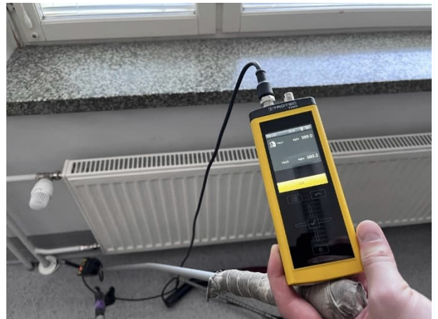
Kuva 153 Ilmavuotoa havaittiin patteriputkien läpivientien kautta.
