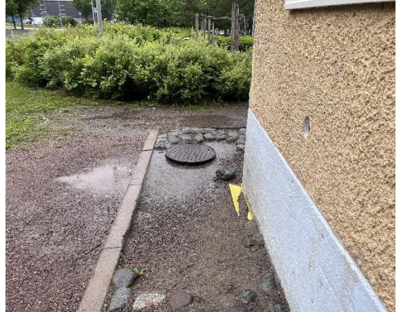
Kuva 130 Vesi lammikoituu etupihan puoleiselle nurkalle, matala osa.
