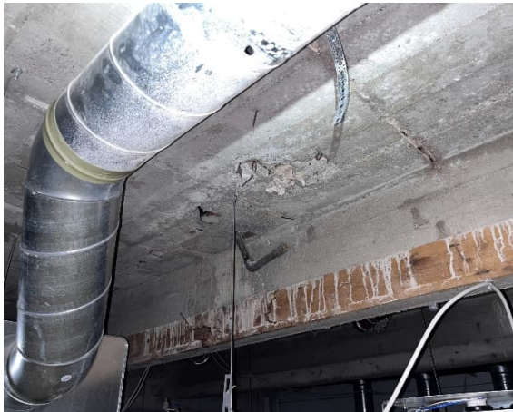
Kuva 96 Muottilautaa ja yläpölyjä, opettajainhuone.
