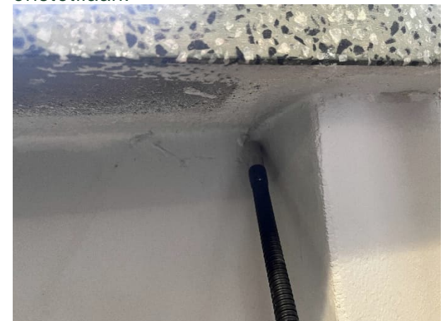
Kuva 159 Runsasta ilmavuotoa havaittiin ikkuna-ulkoseinäliittymän alueelta ikkunapenkin alta.
