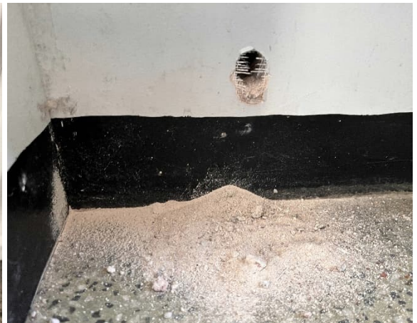
Kuva 54. US18. Avaus on osunut tiilimuurausten saumaan.
