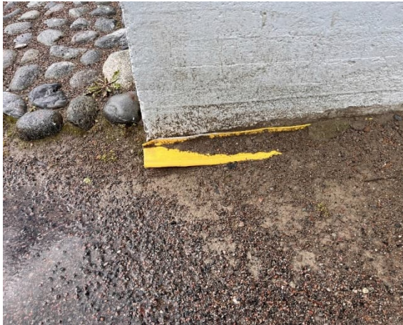
Kuva 23 Matalan osan päädyssä tehtiin havainto Isodränin reunalistasta.
