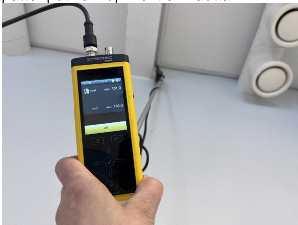
Kuva 154 Merkkiainekaasu kulkeutui yläpohjan eristetilasta alapuoliseen luokkaan.
