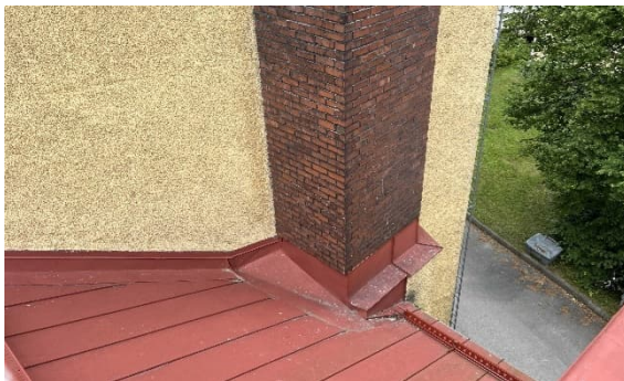
Kuva 121 Savupiipun tiilissä havaittiin rapautumaa.
