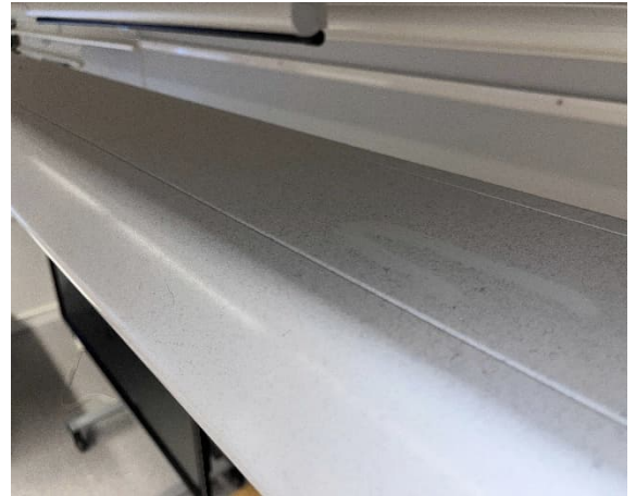
Kuva 183 Pölyä valaisimen päällä.
