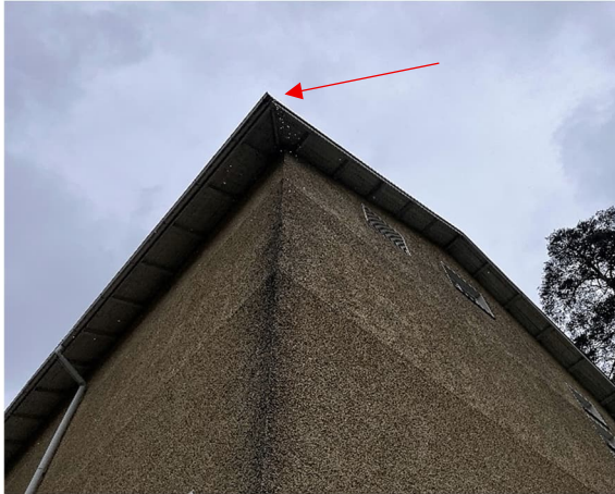
Kuva 129 Matalan osan vesikattoa. Vesi valuu rännikourusta yli.
