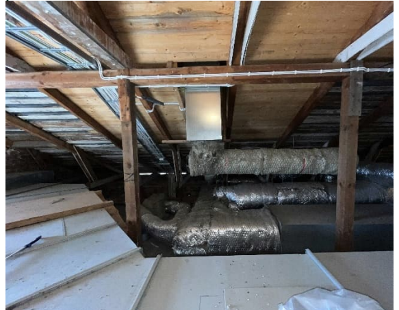
Kuva 132 IV-kanavien lämmöneristeet ovat paikoin rikki.
