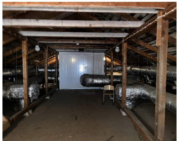
Kuva 134 Eristetty IV-konehuone, matala osa.
