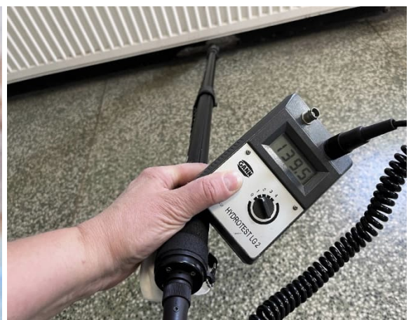
Kuva 50. K01. Ulkoseinän alaosassa havaittiin poikkeavia pintakosteusarvoja. Kyseessä on osittain maanvastainen seinä.
