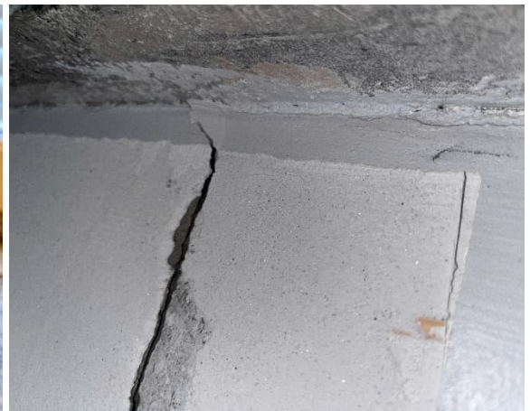
Kuva 56. Ulkoseinien sisäpinnoilla havaittiin paikoin halkeamia. Kuva luokasta 309.
