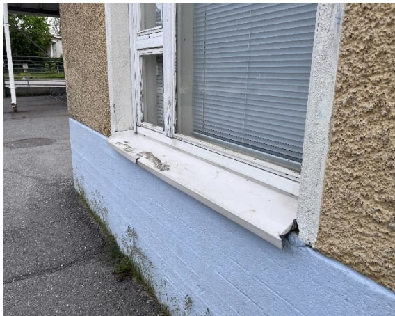
Kuva 47. Ikkunapeltien kaato on paikoin vähäinen. Valtaosin ikkunapeltien kaato on riittävä.
