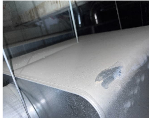
Kuva 95 Yläpölyä, 2.krs käytävä.
