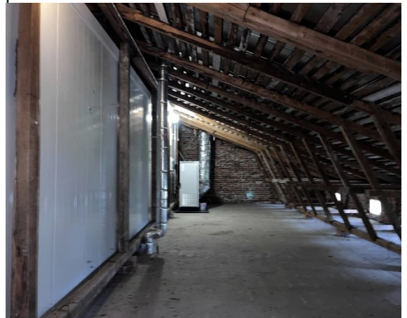
Kuva 138 Korkean osan eristetty IV-konehuone.
