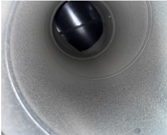
Kuva 190 Poistoilmakanavaa tilassa 317, WC tytöt.
