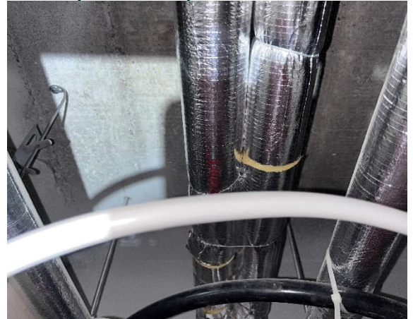
Kuva 103 Putkieristeiden päät avoimia, tila K06.
