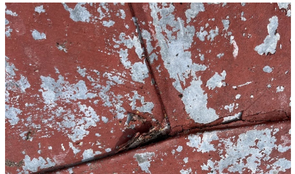
Kuva 116 Maalipinta on kulunut, rakennuksen korkea osa.
