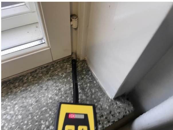
Kuva 158 Runsasta ilmavuotoa havaittiin ikkuna-ulkoseinäliittymän alueelta.
