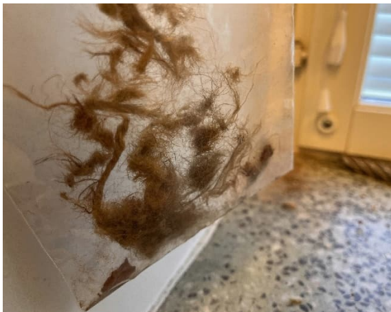
Kuva 55. Ikkunatilkkeinä oli paikoin rivettä. Kuva tilasta 107.
