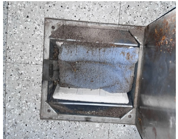
Kuva 85 Ensimmäisen kerroksen käytävän tekniikkaluukussa epäpuhtauksia.
