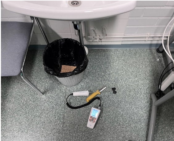
Kuva 36 Viiltokosteusmittausta tilassa K24.
