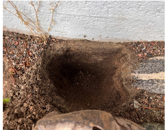
Kuva 24 Etupihan puoleisella sivulla ei havaittu sokkelin ulkopuolista vedeneristystä.
