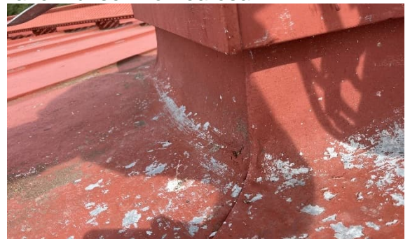
Kuva 118 Maalipinta on kulunut, rakennuksen korkea osa.
