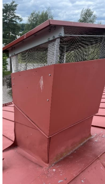
Kuva 124 Huippumuri piti poikkeavaa ääntä tutkimushetkellä.
