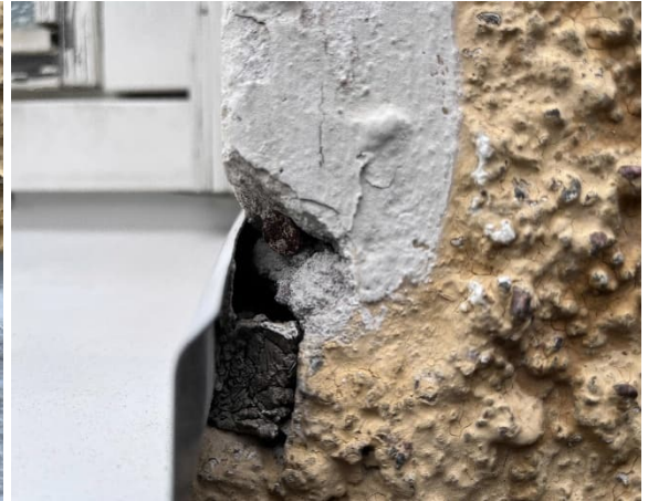
Kuva 46. Ulkoseinärappauksessa on epätiiveyksiä ja teräkset ovat näkyvillä.
