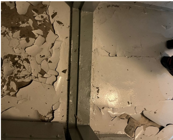
Kuva 38 Maalipinnoite irronnut alustastaan tilassa K58/K02.
