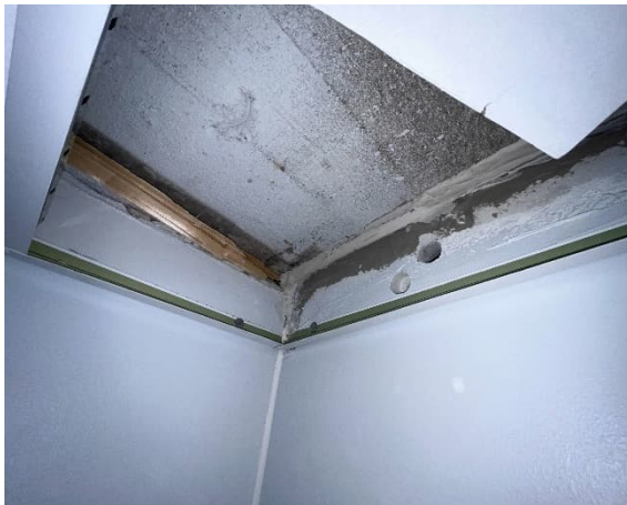
Kuva 108 Avoin läpivienti IV-hormiin, luokka 309.
