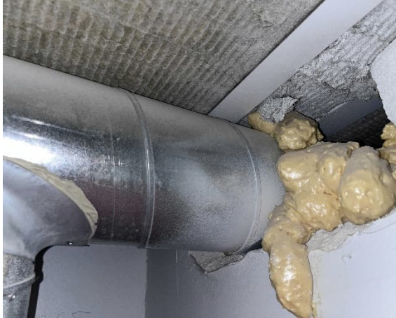
Kuva 82 Tyttöjen WC-tila 223. Avoimia mineraalivillapintoja ja epätiivis läpivienti.
