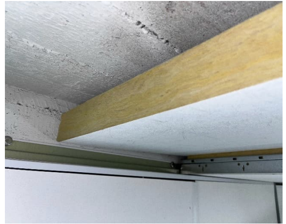
Kuva 89 Akustiikkalevyt ovat valtaosin reunoiltaan pinnoittamattomia. Esimerkkikuva tilasta K06.
