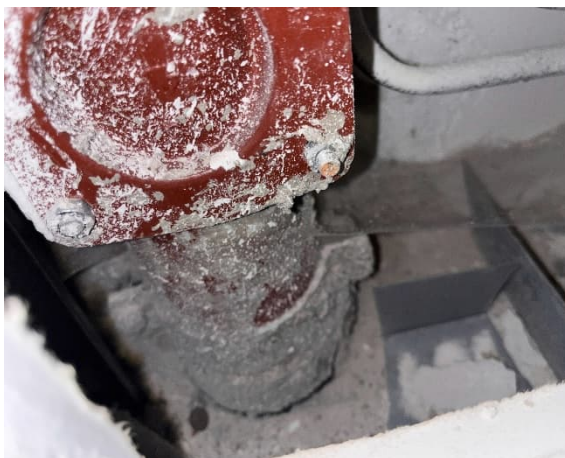
Kuva 92 Kotelointien sisällä havaittiin epäpuhtauksia.
