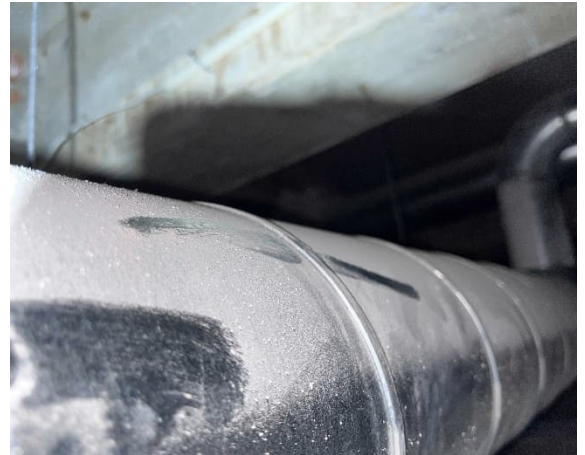
Kuva 79 Yläpölyä IV-kanavan pinnalla.
