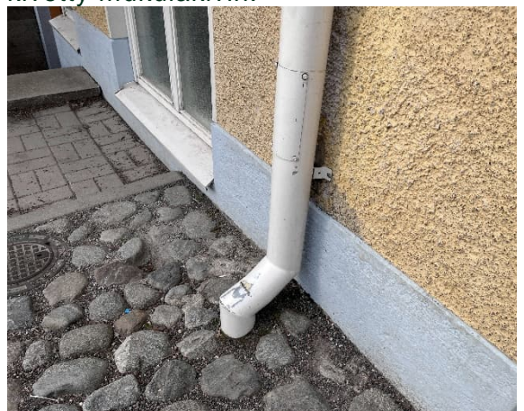
Kuva 22 Sadevedet ohjataan syöksytorvien avulla sadevesijärjestelmään.
