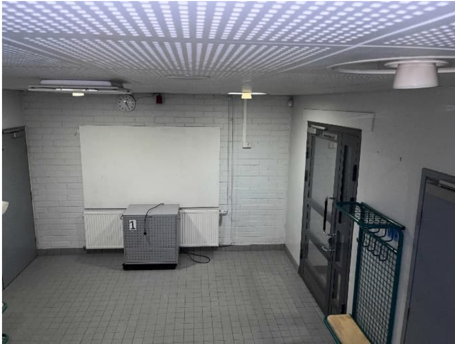
Kuva 77 Kellarikerroksen aulassa havaittiin tiilimuurattuja väliseiniä.
