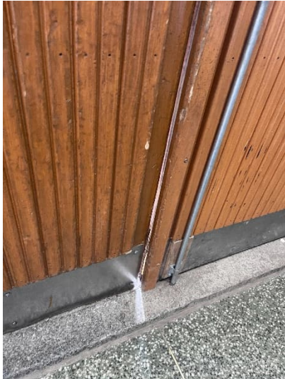
Kuva 57. Ulko-ovi on epätiivis.
