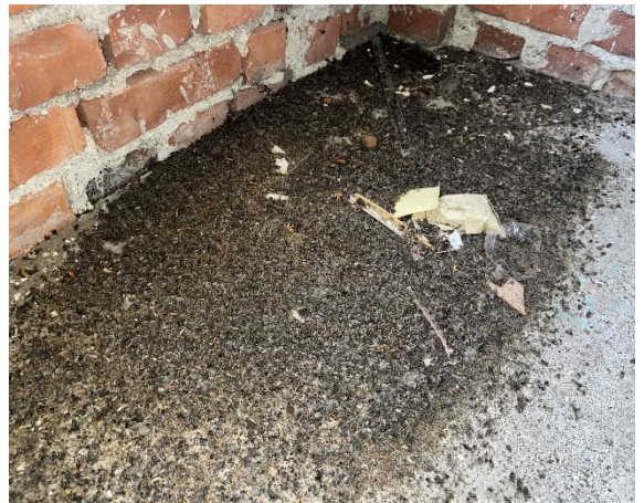
Kuva 140 Korkean osan yläpohjassa havaittiin runsaasti kuolleita hyönteisiä ja arviolta lintujen ulostetta.
