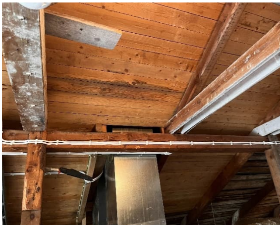
Kuva 127 Matalan osan vesikaton puuosissa havaittiin paikoin vanhoja kosteusjälkiä.
