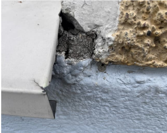
Kuva 45. Ikkunarakenteiden saumat ovat ikääntyneitä.
