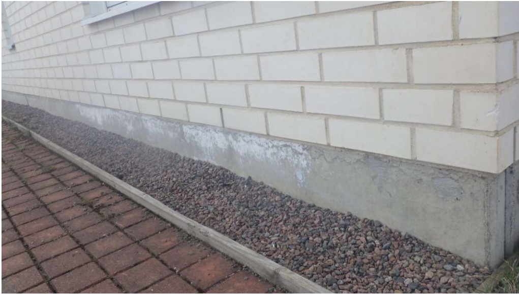
Kuva 4. Sokkelin pinnassa havaittiin paikoin kosteusrasitukseen viittaavaa kalkkihärmää.
