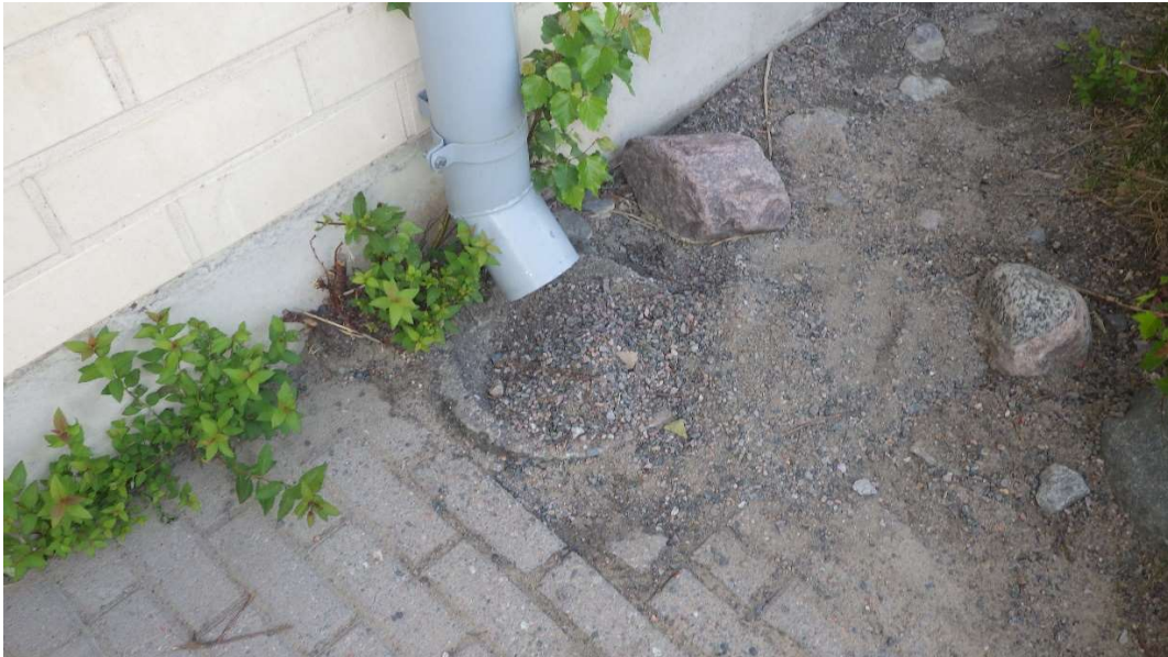
Kuva 3. Sadevesien ohjauksessa havaittiin paikoin puutteita.
