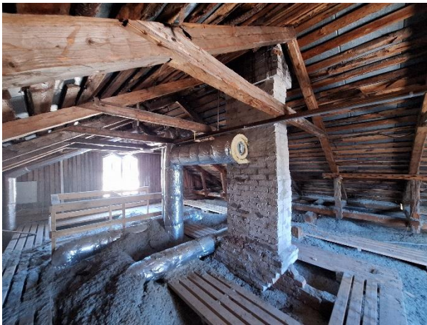
Likainen poistoilma on kanavoitu tiilihormiin.
