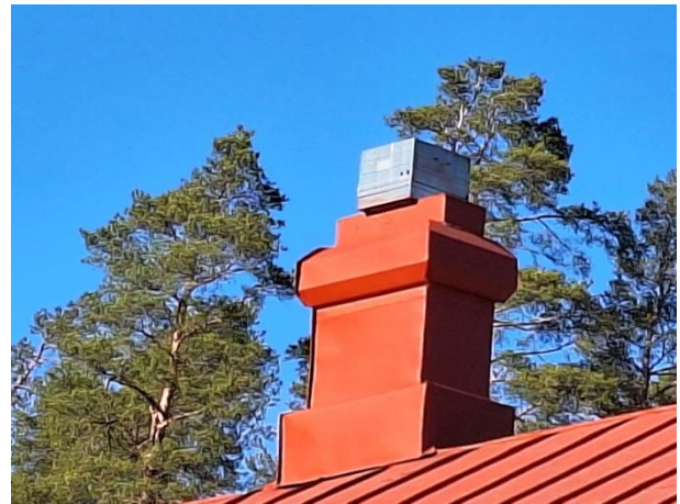
Vesikatolla ollut kokoojalaatikko ja huippuimuri.
