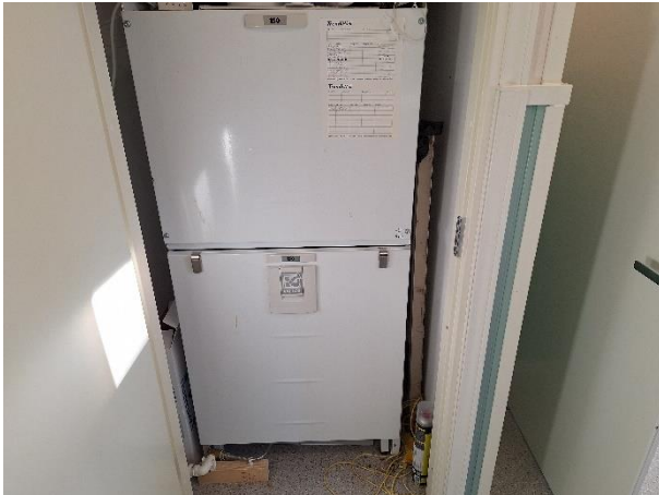
Ilmanvaihtokone TK-1 Vallox 150 SE.
