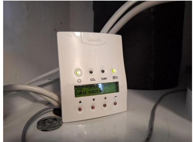
Ilmanvaihtokoneen TK-1 ohjain.
