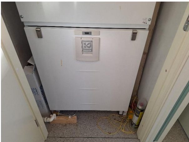
Koje TK-1 sijaitsee omassa laitetilassaan.
