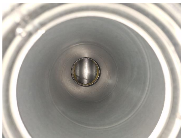
Poistoilmakanavaa. Kanava puhdas.
