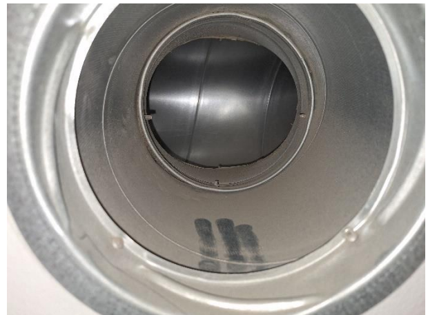
Poistokanavassa alkavaa pölykertymää, luokka 205.
