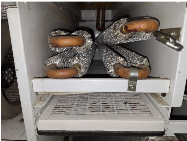
Vesikiertoinen tuloilman jälkilämmityspatteri.
