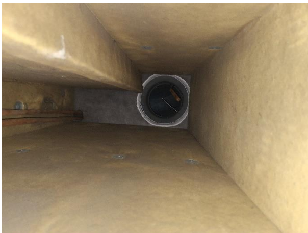
Tiloihin lähtevän tuloilman kammionäkymää.
