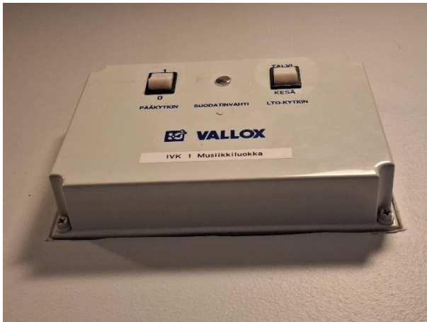
Ilmanvaihtokoneen TK01 ohjaukskytkimet.
