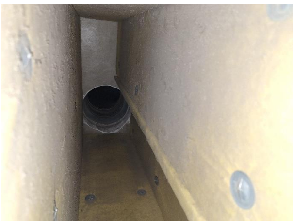
Tiloista palaavan poistoilman kammionäkymää.
