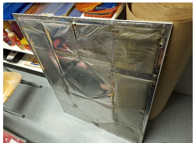
Ilmanvaihtokoneen TK05 etukansi.
