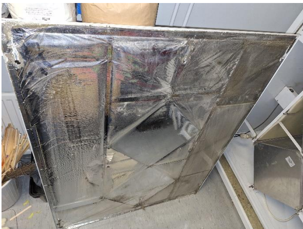
Ilmanvaihtokoneen TK04 etukansi.
