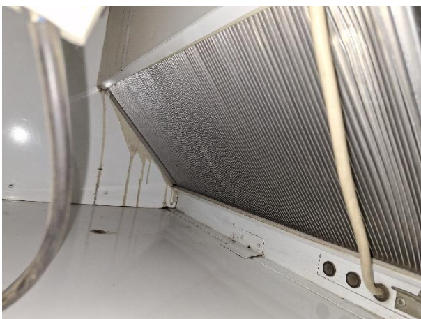
Tuloilmakammio oli puhdas.
