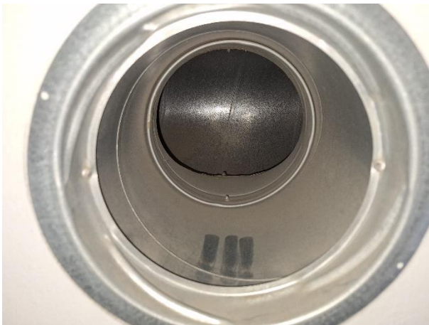
Poistokanavassa alkavaa pölykertymää, luokka 104.
