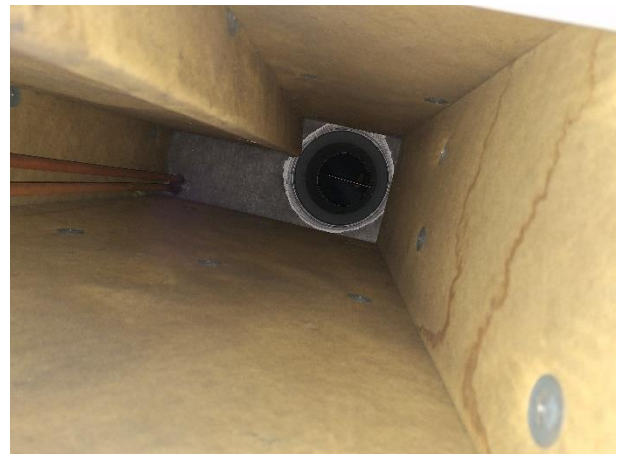
Tiloihin lähtevän tuloilman kammionäkymää.
