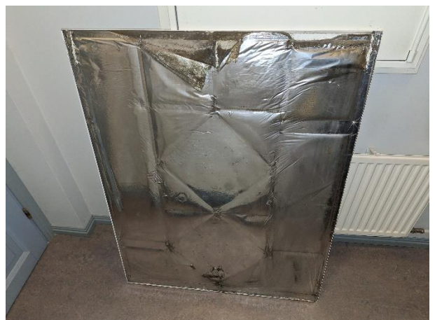
Ilmanvaihtokoneen TK02 etukansi.
