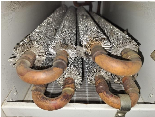
Vesikiertoinen tuloilman jälkilämmityspatteri.
