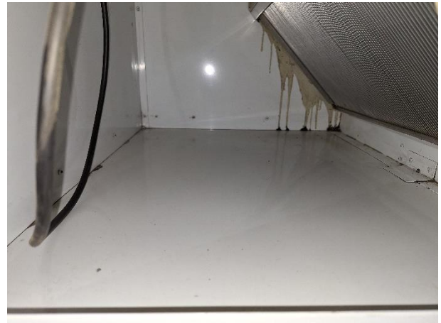
Tuloilmakammio oli puhdas.
