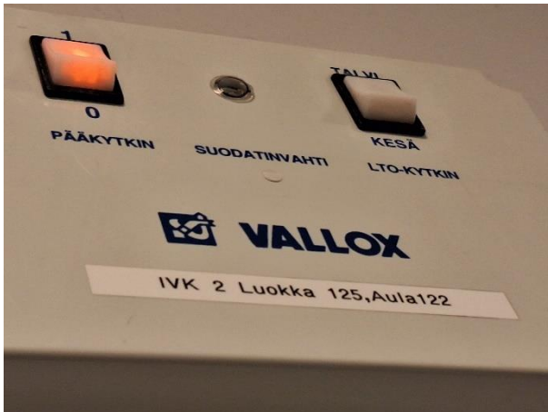
Ilmanvaihtokoneen TK02 ohjaukskytkimet.
