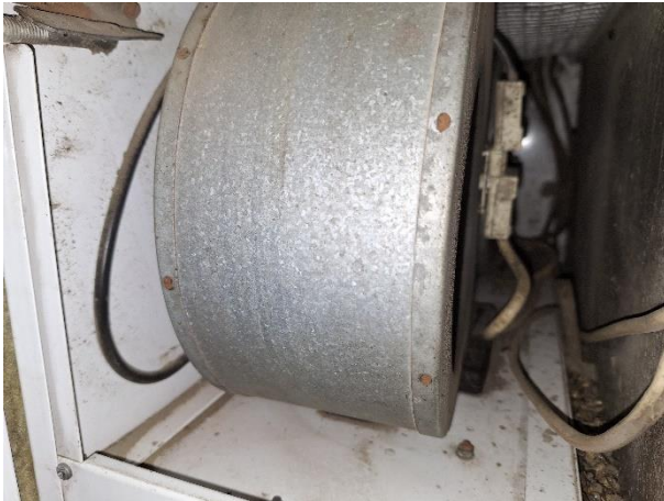
Tuloilmapuhaltimet 2 kpl. Kammio likainen.
