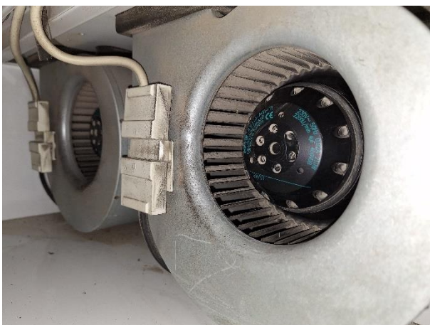
Poistoilmapuhaltimet 2 kpl TK06.
