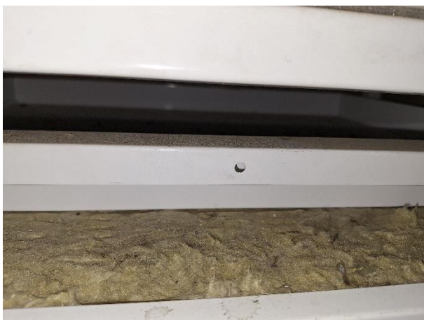
Kojeen alla on näkyvillä äänenvaimennusvillaa.
