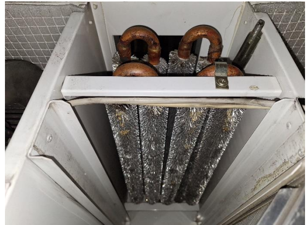
Vesikiertoinen tuloilman jälkilämmityspatteri.
