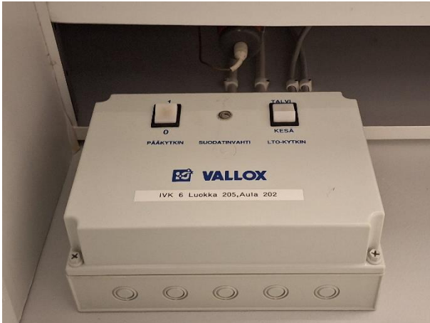
Ilmanvaihtokoneen TK06 ohjaukskytkimet.
