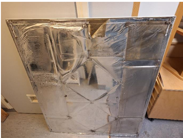
Ilmanvaihtokoneen TK03 etukansi.
