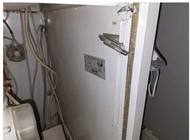
Kojeen sivuilla on näkyvillä äänenvaimennusvillaa.
