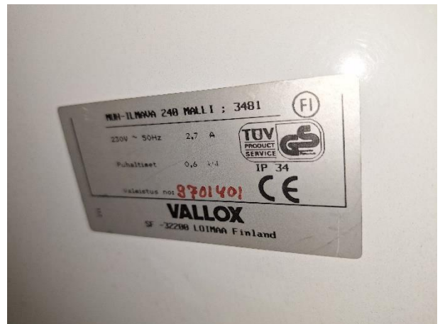
Ilmanvaihtokoneen TK03 valmistekyltti.
