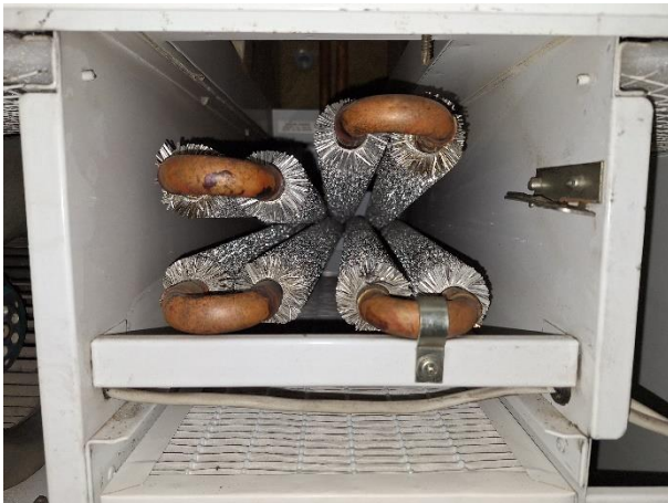
Vesikiertoinen tuloilman jälkilämmityspatteri.
