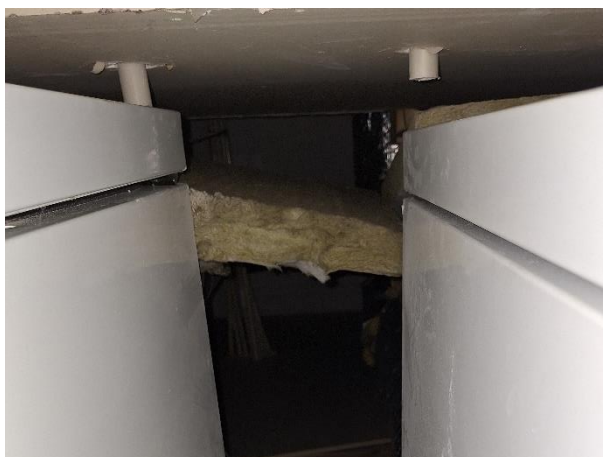
Ilmanvaihtokoneen alla, sivuilla ja laitetilassa villaa.
