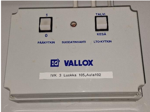
Ilmanvaihtokoneen TK03 ohjaukkytkimet.
