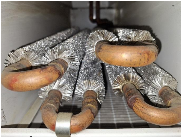
Vesikiertoinen tuloilman jälkilämmityspatteri.
