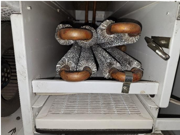
Vesikiertoinen tuloilman jälkilämmityspatteri.
