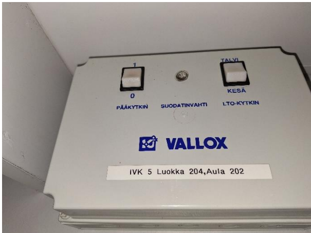
Ilmanvaihtokoneen TK05 ohjaukkytkimet.
