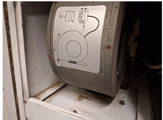
Tuloilmapuhaltimet 2 kpl TK06.
