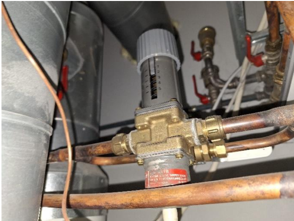
TK06 vesikiertojälkilämmityspatterin ohjausventtiili.
