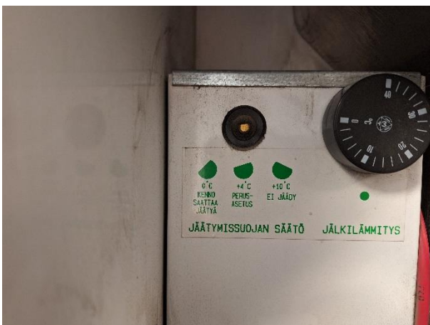
Jäätymissuoja- ja jälkilämmitysasetukset ok.
