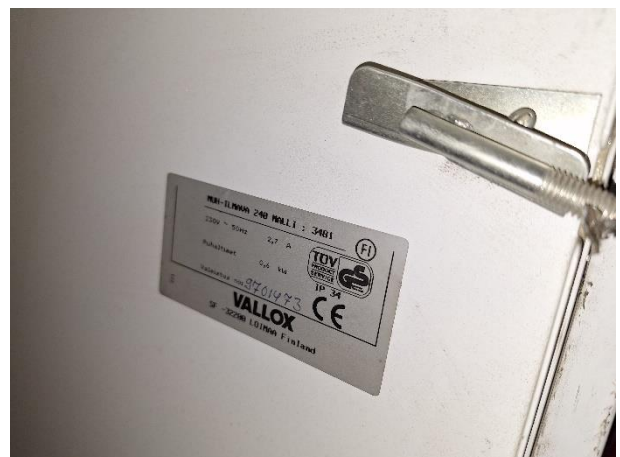
Ilmanvaihtokoneen TK04 valmistekyltti.
