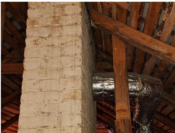
Likainen poistoilma kanavoitu tiilihormiin.
