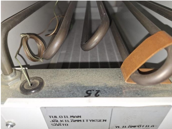
Tuloilman jälkilämmitysvastus 2,5 kW.
