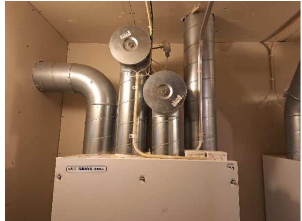
Ilmanvaihtokone TK-10 kanavalähtöjä.
