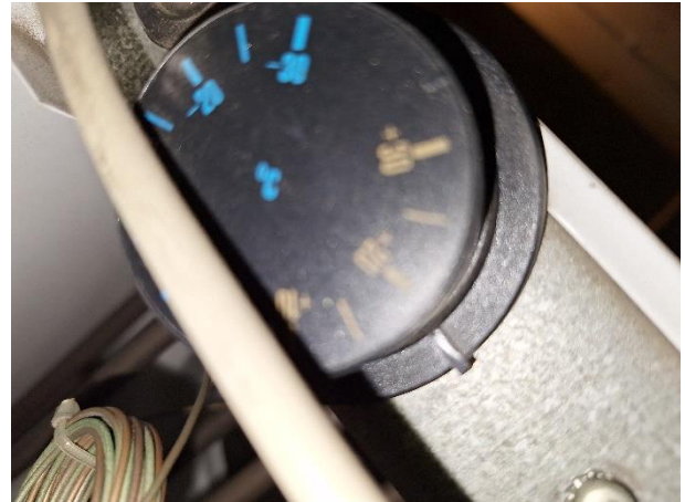
Lämpötilaksi asetettu noin 19 °C.
