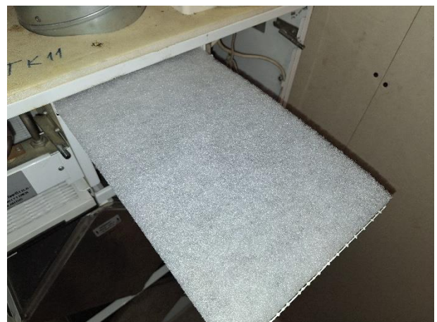
Poistoilman suodatin oli puhdas.
