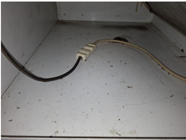
Tuloilmakammio tulisi puhdistaa.
