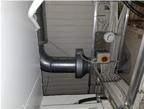
Poistoilmakone PK-11 sähköpääkeskustilassa.
