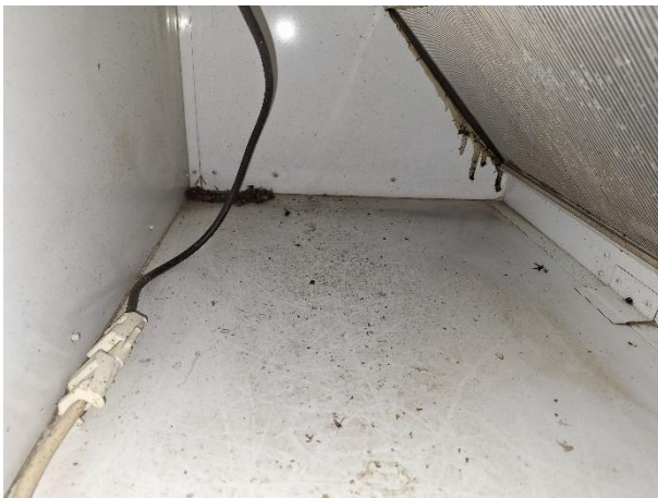
Tuloilmakammio tulisi puhdistaa.
