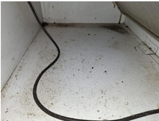
Tuloilmakammio tulisi puhdistaa.
