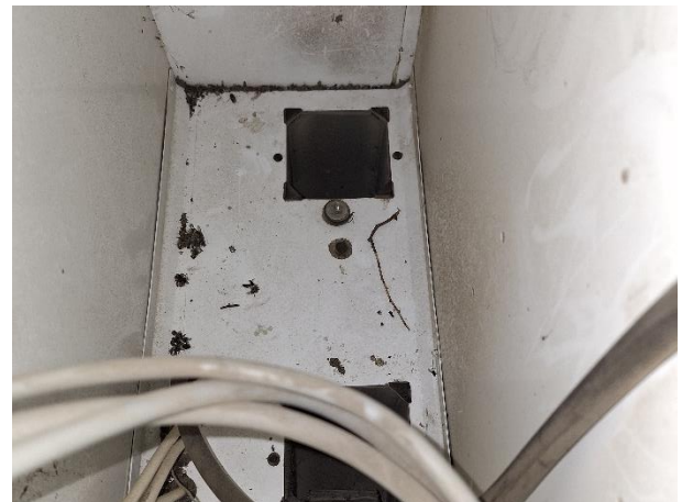
Poistoilmakammio tulisi puhdistaa.
