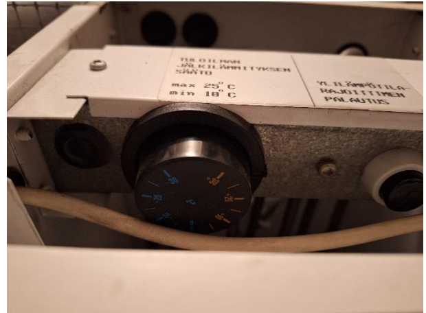
Lämpötilaksi asetettu noin 19 °C.
