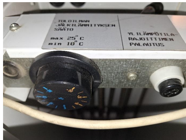
Lämpötilaksi asetettu noin 19 °C.
