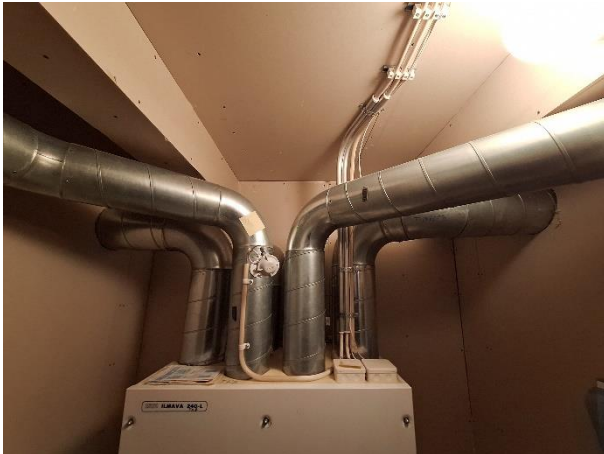
Laitetilassa kanavia ei ole eristetty.
