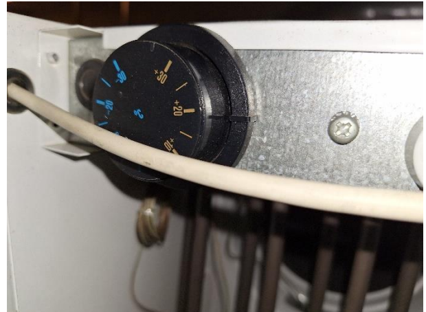
Lämpötilaksi asetettu noin 19 °C.
