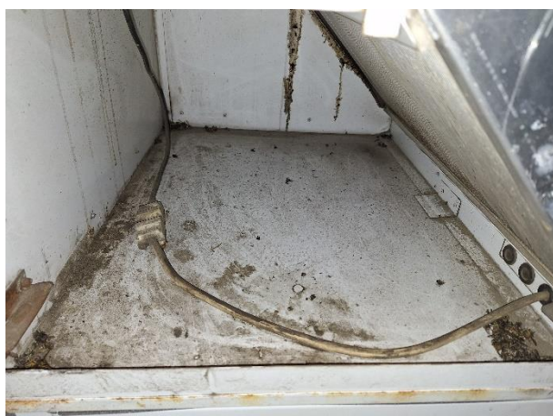
Tuloilmakammio tulisi puhdistaa.
