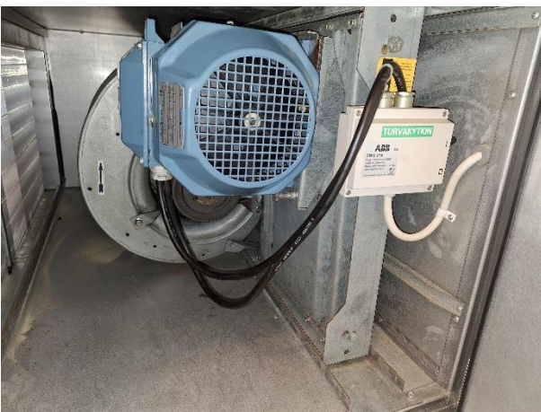
Tuloilmapuhallin TF01 (TK/PK-3).
