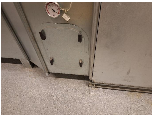
Tuloilmakammion tarkastusluukku, TK/PK-1.
