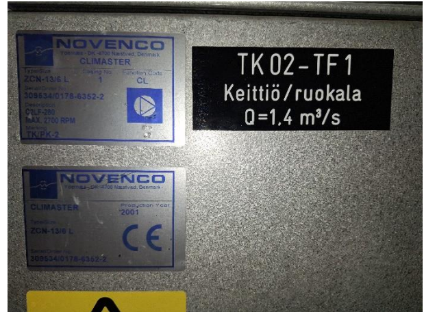
Tuloilmapuhallin TF01 (TK/PK-2).
