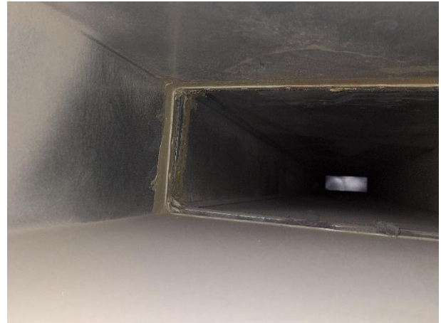
Näkymä poistoilmakanavaan, luokkahuone K15.
