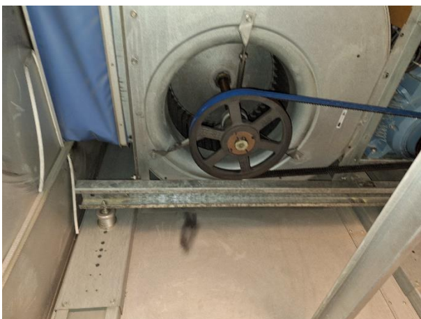
Tuloilmapuhallin TF01 (TK/PK-1).
