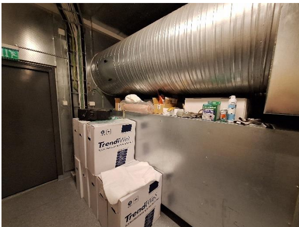
Tulo- ja poistoilmakanavointia, TK/PK-1.
