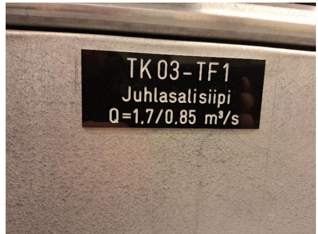
Tuloilmapuhallin TF01 (TK/PK-3).
