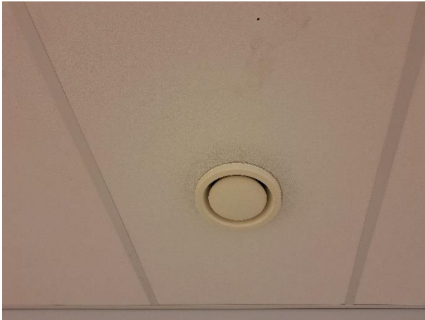
Poistoilmaventtiili, luokkahuone K15.
