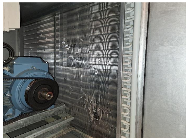
Tuloilman lämmityspatteri (TK/PK-1).
