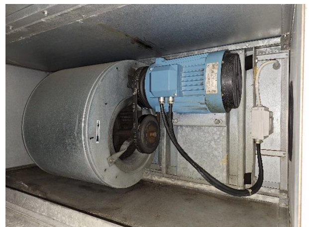
Poistoilmapuhallin PF01 (TK/PK-2).
