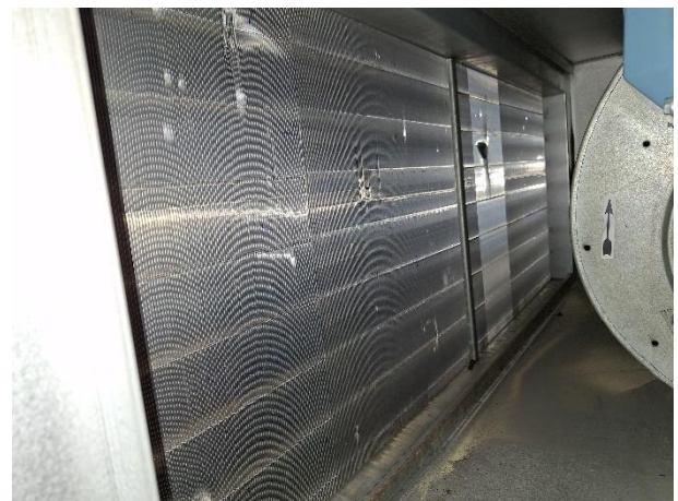
Tuloilman lämmityspatteri (TK/PK-3).
