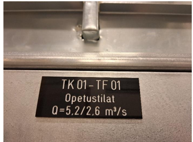
Tuloilmapuhallin TF01 (TK/PK-1).
