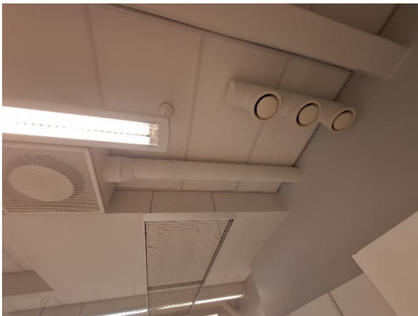
Luokan tuloilmalaite ja kartiopoistoventtiilejä.
