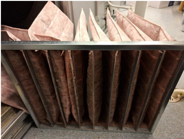
Tuloilmasuodattimet olivat likaisia (TK/PK-3).
