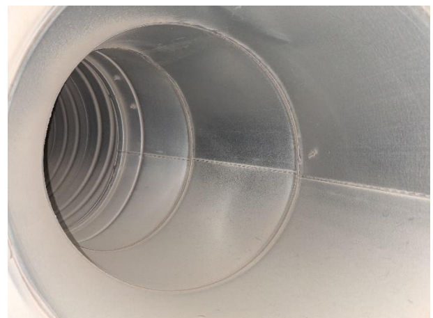
Poistoilmakanavan pölykertymää (TK/PK-3).
