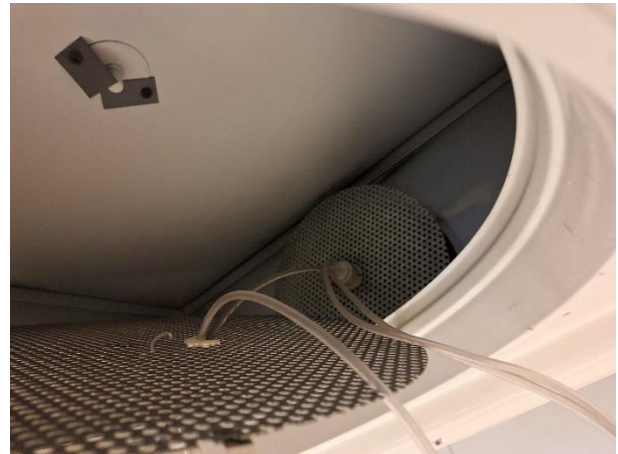
Luokan tuloilmalaitteet mallia Halton TBV-200.
