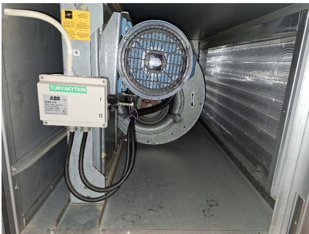
Tuloilmapuhallin TF01 (TK/PK-2).
