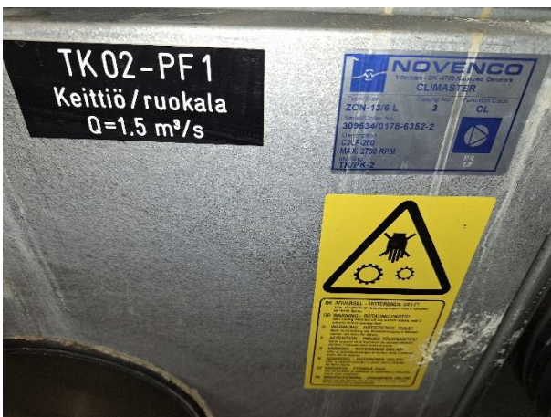
Poistoilmapuhallin PF01 (TK/PK-2).
