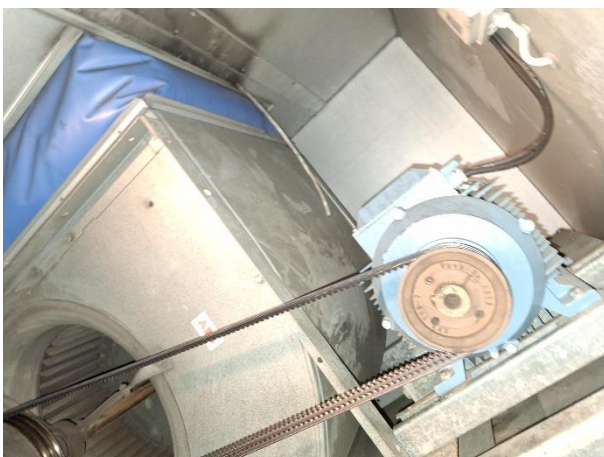
Poistoilmapuhallin PF01 (TK/PK-1).
