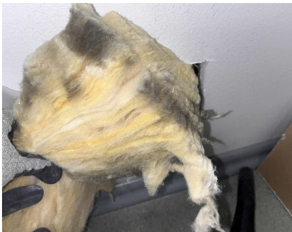
Kuva 66 US 13. Ulkoseinän lämmöneristeissä havaittiin ilmavuodon aiheuttamaa tummentumaa.
