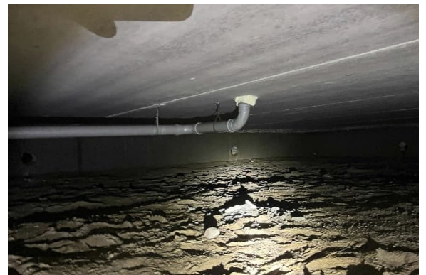
Kuva 28 Ryömintätilaan pääsee paikoin kosteutta läpivientien kautta (tuuletusputki).
