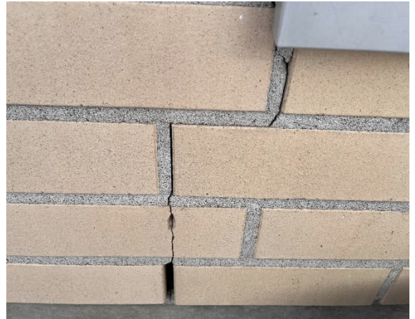
Kuva 44 Halkeamia ulkoseinän tiilimuurauksessa.
