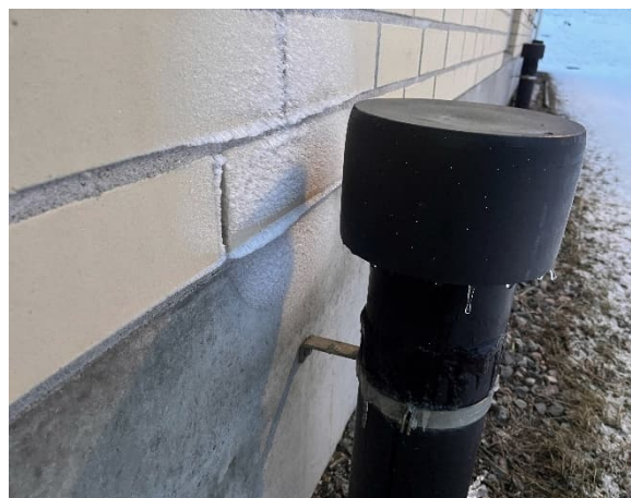
Kuva 42 Tuuletusputkien kautta tuleva lämmin ja kostea ilma jäätyy ulkoseinän ulkopintaan.
