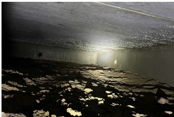
Kuva 27 Ryömintätilaa. Alapohjalaatan alapinnassa helmeilee vesipisaroita.
