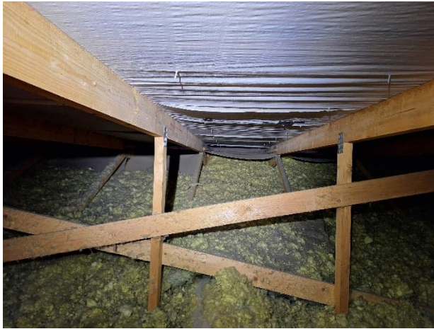
Kuva 97. Pieneläinverkon tiiveydessä havaittiin puutteita.
