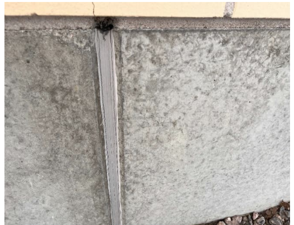
Kuva 46 Sokkelielementin saumoissa havaittiin paikoin halkeilua.
