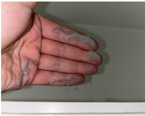
Kuva 17 Lepohuoneiden kaappisänkyjen päällä havaittiin runsasta pölykertymää.
