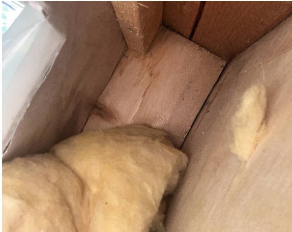
Kuva 64 US 12. Ikkunan alapuolisissa puurakenteissa havaittiin kosteusjälkiä.
