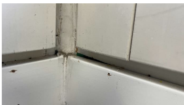
Kuva 106 Rakenneliittymiä on arviolta tiivistetty massalla ja höyrynsulkuteipillä jollain aikavälillä.
