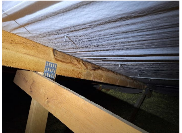
Kuva 98. Viemärin tuuletusputken alla havaittiin kosteusjälkiä.
