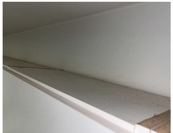
Kuva 18 Kaappisänkyjen päällä havaittiin yläpölyä.
