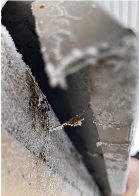
Kuva 43 Tuuletusputken kautta tuleva lämmin ja kostea ilma jäättyi paikoin myös ikkunapellityksen alle/ulkoseinään.
