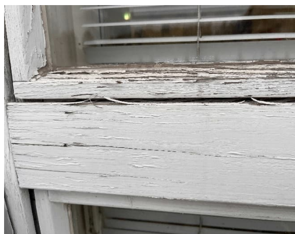
Kuva 40 Ikkunoiden maalipinnat hilseilee.
