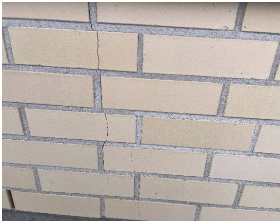
Kuva 45 Halkeamia ulkoseinän tiilimuurauksessa.
