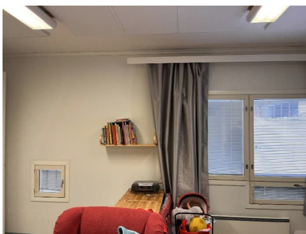
Kuva 107 Tiloissa havaittiin paikoin kattolistoja. On mahdollista, että rakenteita on tiivistetty aiemmin.
