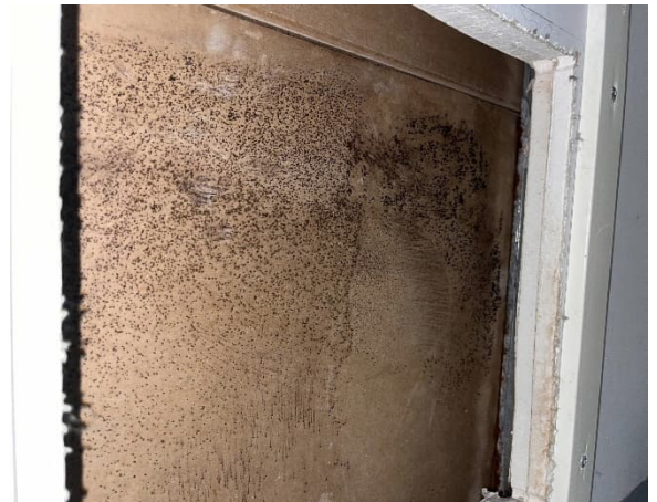
Kuva 79 Rakenneavaus [VS3]. Keittiön puoleisen kipsilevyn sisäpinnalla havaittiin mikrobikasvua.
