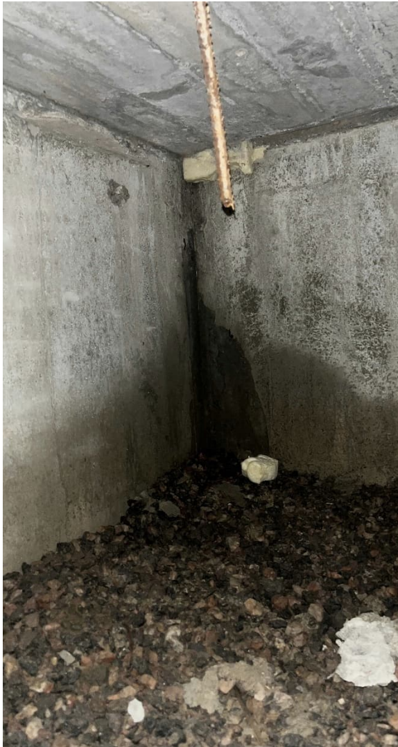
Kuva 33 Ryömintätilaan pääsee paikoin kosteutta esim. puutteellisen salaojituksen tai sadevesien ohjauksen vuoksi.
