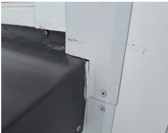
Kuva 52 Ikkunapellitusten tiivistykset ovat puutteellisia.
