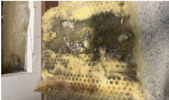
Kuva 63 US5. Tuulensuojavillan ulkopinnassa havaittiin tummumaa.
