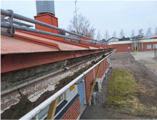
Kuva 89. Sadevesikourun pohjalla roskaa.
