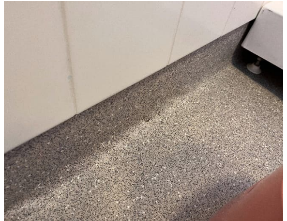
Kuva 16 WC-tilojen lattiamatossa ylösnostojen taitteissa havaittiin paikoin reikiä.
