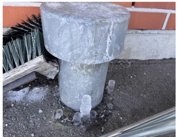
Kuva 40 Ryömintätilan tuuletusputkea. Kondenssivesi tippuu maahan ja jäätyy putken ulkopuolelle.
