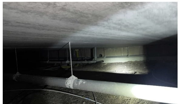
Kuva 36 Läpivientejä ja kannakointeja.
