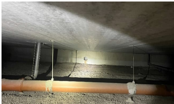
Kuva 45 Läpivientejä ja kannakointeja.
