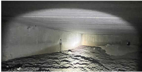
Kuva 41 Tuuletusputken alueella sokkelirakenteessa on havaittavissa kosteusjälkeä.
