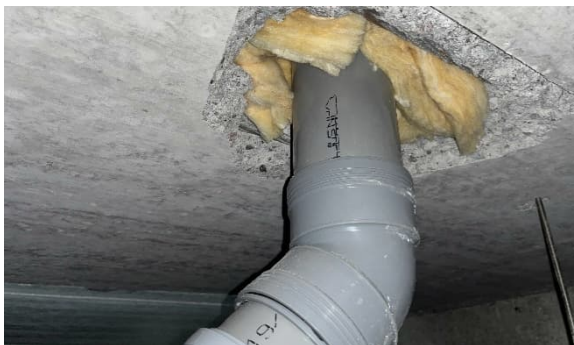
Kuva 35 Läpiviennit ovat epätiivitä.
