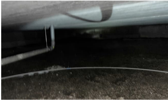
Kuva 37 Ryömintätila oli paikoin kostean oloista.
