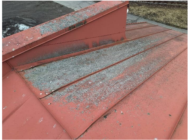
Kuva 84. Vesikatteella on paikoin sammalta.
