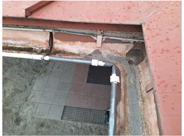
Kuva 90. Sadevesikourujen sisätaitteissa havaittiin vuotoja.
