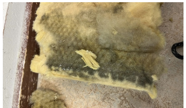
Kuva 60 US7. Tuulensuojavillan ulkopinnassa havaittiin tummumaa.
