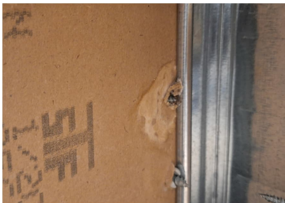
Kuva 77 Yleiskuva rakenteen sisältä [VS2]. Ruuvien reiän kohdalla arviolta kosteusjälkeä.
