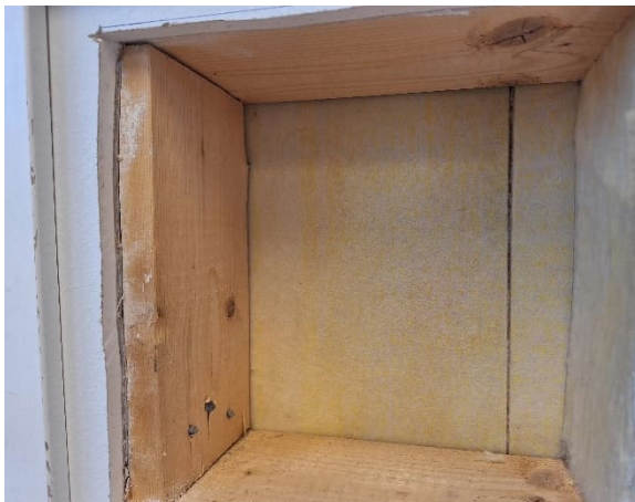
Kuva 69 US 12. Tuulensuojavillan sisäpinnalla havaittiin vuotojälkiä.
