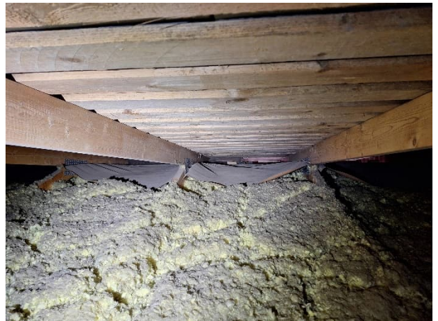
Kuva 92. Pieneläinverkko on asennettu puutteellisesti.
