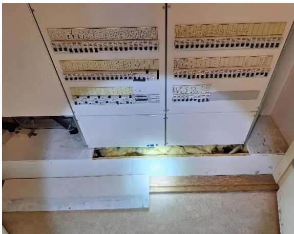
Kuva 17 Sähkökaapin kotelointi on tukittu villalla.
