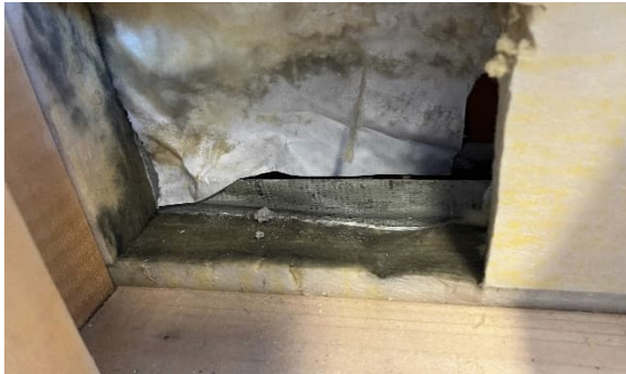
Kuva 61 US 6. tuulensuojavillassa havaittiin ilmavuodon aiheuttamaa tummumaa. Tuulensuojavillalevyjä oli teipattu ilmastointiteipillä.
