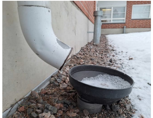
Kuva 25 Sadevesien ohjausta. Sadevedet eivät ohjaudu rännikaivoon.
