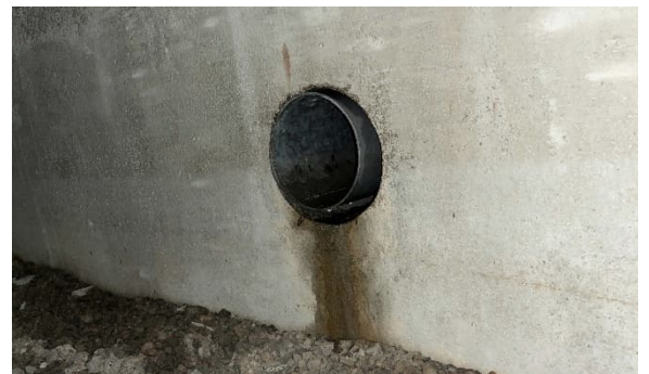
Kuva 32 Ryömintätilaan pääsee paikoin kosteutta läpivientien kautta (tuuletusputki).
