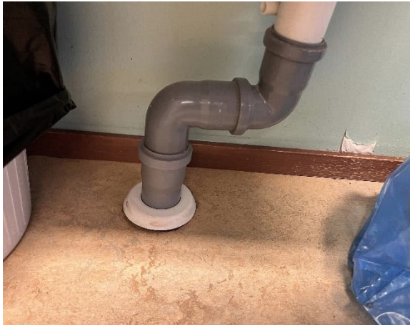
Kuva 15 Käsienpesualtaan alla väliseinässä havaittiin vähäistä lievää kosteusjälkeä pienellä alueella.
