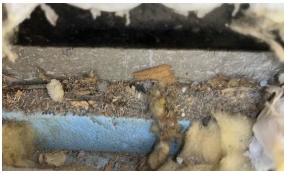
Kuva 65 US 5. Rakenneavauksessa havaittiin runsaasti rakennusmateriaalijätettä.
