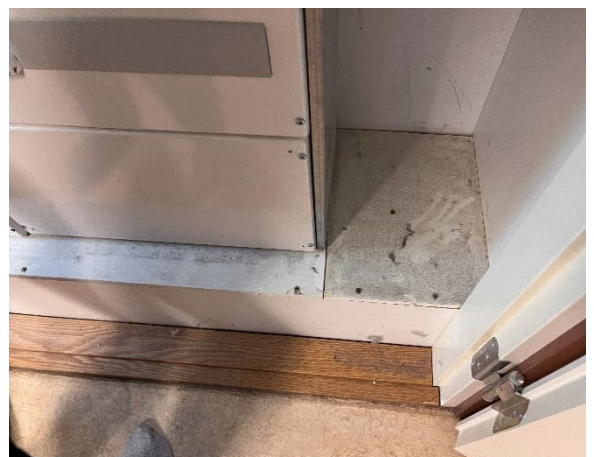
Kuva 14 Sähköpääkeskuksen koteloinnissa havaittiin runsaasti pölyä ja likaa.
