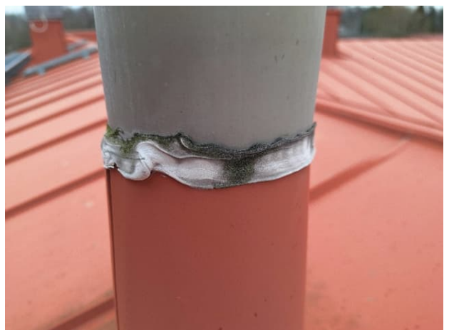
Kuva 86. Tuuletusputken ja tyvikartion liitoksen tiivistysmassa on haurastunut.
