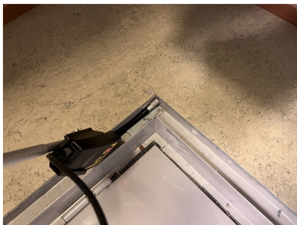
Kuva 100 Ilmapuotoa havaittiin myös luukkujen rakenneliittymien kautta.
