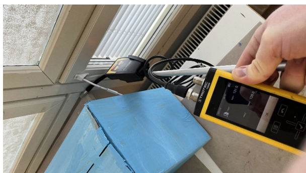
Kuva 101 Ilmapuotoa havaittiin ikkuna-ulkoseinäliittymien kautta.
