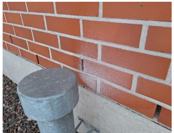
Kuva 53 Tuuletusputken kautta tuleva lämmin ja kostea ilma jäätyy ulkoseinän pintaan.
