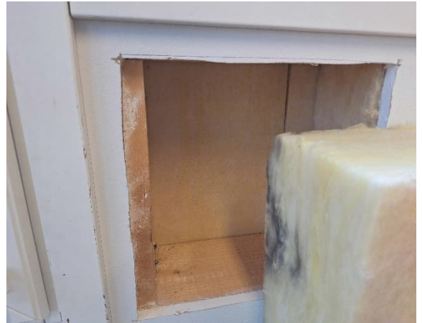
Kuva 68 US12. Ulkoseinärakennetta ikkunan vierestä. Villoissa on lievää ilmavuodon aiheuttamaa tummumaa.
