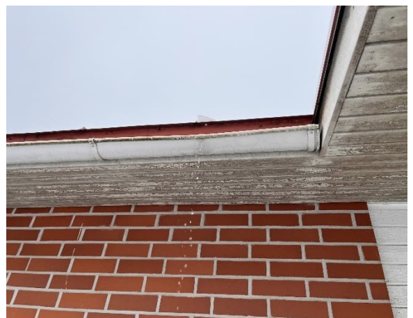
Kuva 27 Sadevesikouru tiputtaa vettä.
