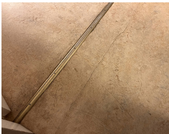
Kuva 13 Linoleumissa havaittiin paikoin halkeilua.
