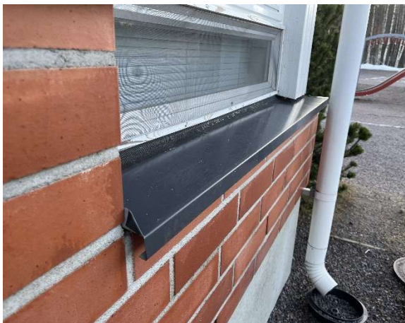
Kuva 54 Ikkunapellitysten kaato oli paikoin vähäinen.
