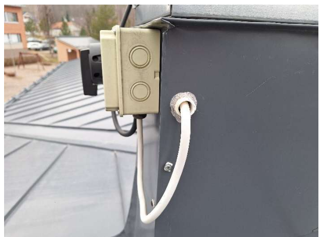
Kuva 104. IV-koneen virtajohdon läpivienti ei ole tiivis.
