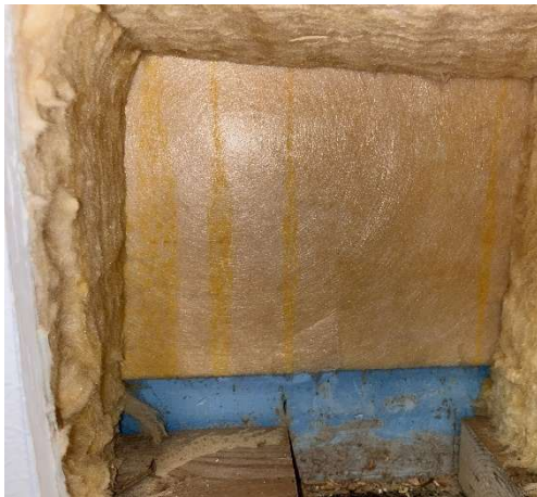
Kuva 77 Rakenneavaus US6. Tuulensuojavillan päällä havaittiin muutamia valumajälkiä.
