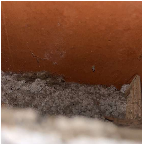
Kuva 81 Rakenneavaus US7. Tiilimuurauksen takan havaittiin laastipurseita.
