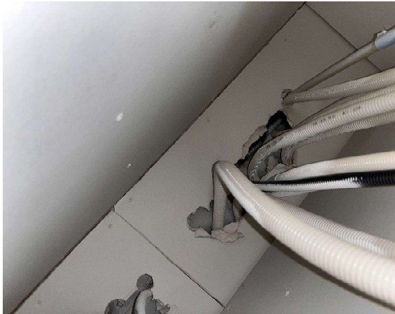
Kuva 97 Epätiivitä läpivientejä sähkökaapin sisäkatossa.
