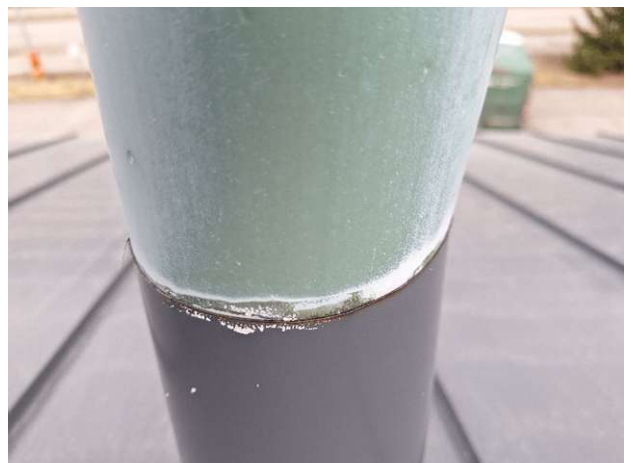
Kuva 102. Tuuletusputken ja tyvikartion liitoksessa ei ole tiivistysmassaa.
