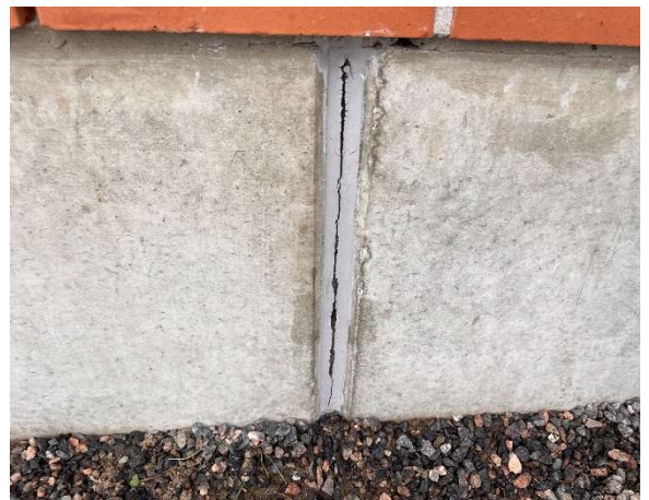
Kuva 38 Sokkeleiden saumat ovat paikoin halkeilleet.
