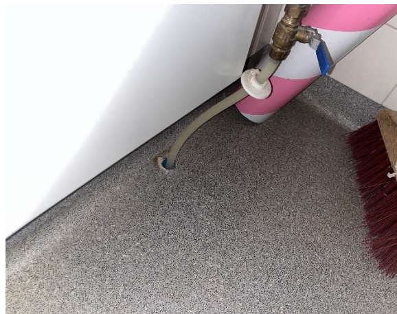
Kuva 17 Epätiivis läpivienti kuraeteisessä/jänönhännät.
