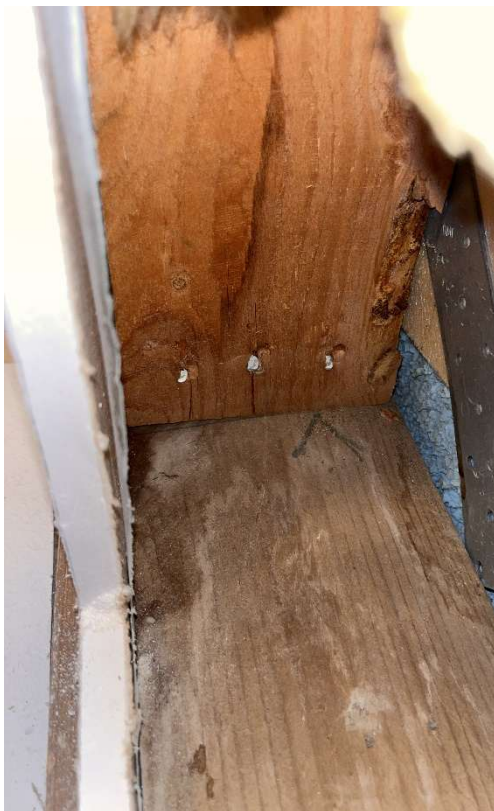
Kuva 69 Rakenneavaus US5. Kosteusjälkiä alaohjauspuun pinnalla.
