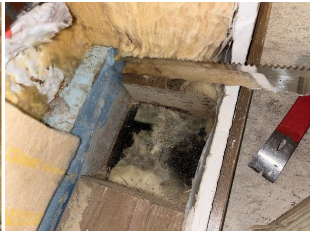
Kuva 78 Rakenneavaus US6. Polyuretaanilevyn pinnassa on betonia ym. likaa.
