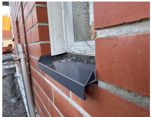
Kuva 55 Ikkunapellitysten kaato oli paikoin vähäinen.
