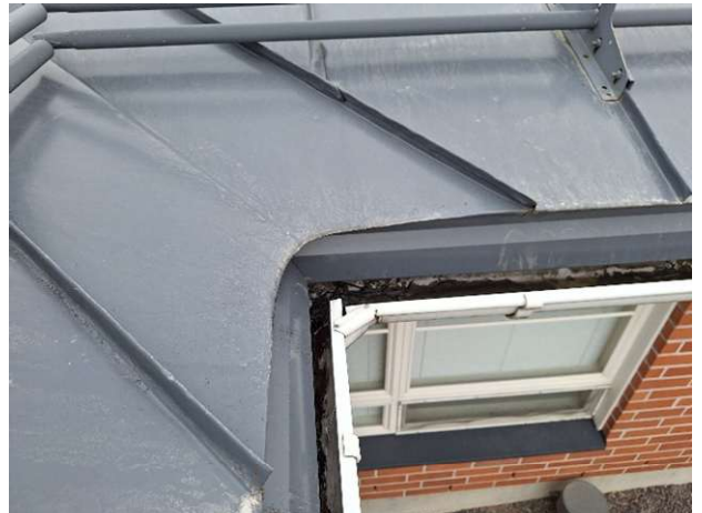
Kuva 106. Sadevesikourujen sisätaitteissa havaittiin vuotoja.
