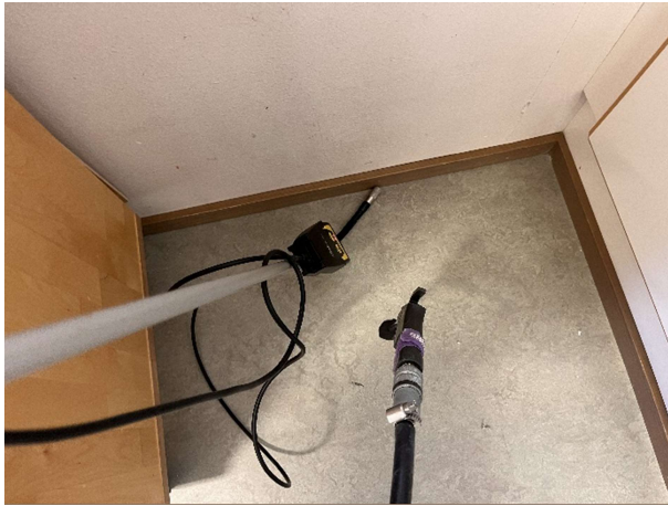
Kuva 120 Runsasta ilmavuotoa havaittiin ulkoseinä-alapohjan eristetilän kautta.
