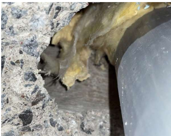
Kuva 45 Läpiviennit ovat epätiivitä.
