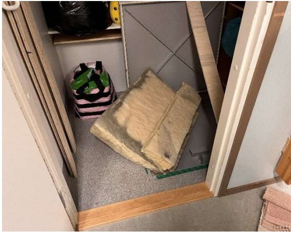
Kuva 47 Ryömintätilan käyntiluukkujen välissä oli mineraalivillaa.
