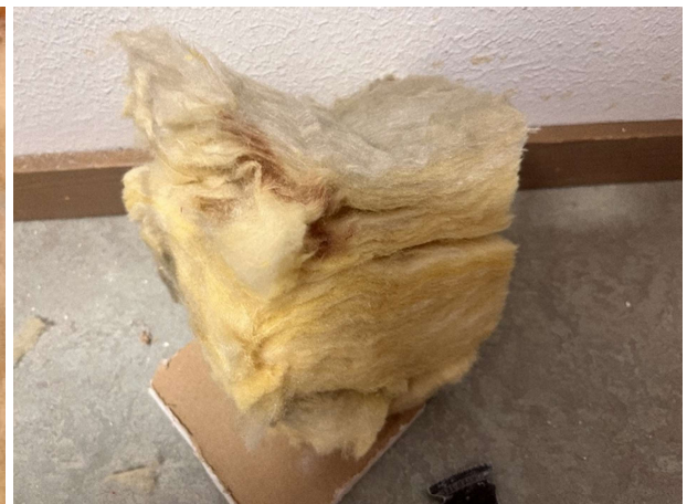
Kuva 84 Rakenneavaus US8. Ulkoseinän lämmöneristeen ulkopinnalla havaittiin rusehtavaa väriä, mikä voi olla esim. ruostetta. Lämmöneristeessä ei todettu mikrobikasvua.
