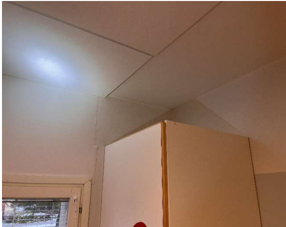
Kuva 28 Kaapin yläpuolella ulkoseinässä havaittiin kosteusjälkiä. Tähän tehtiin rakenneavaus. Rakenteissa ei havaittu poikkeavaa.
