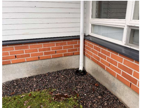
Kuva 36 Sadevesien ohjausta. Katolta tippuvat roiskevedet kastelevat sokkelin aluetta.
