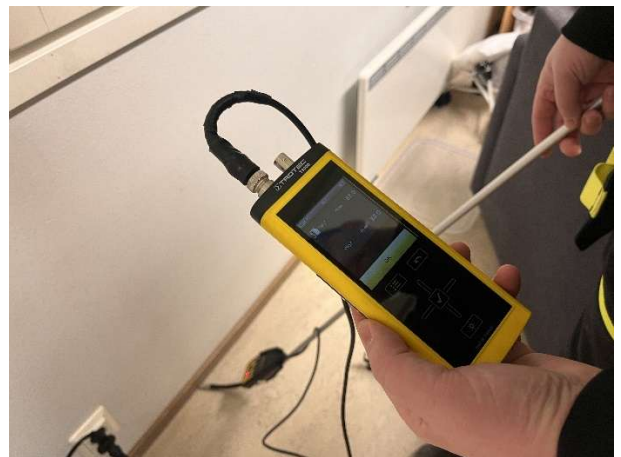
Kuva 113 Merkkiainekaasu kulkeutui alapohjan eristetilan ja ulkoseinäliittymän välistä sisäilmaan.
