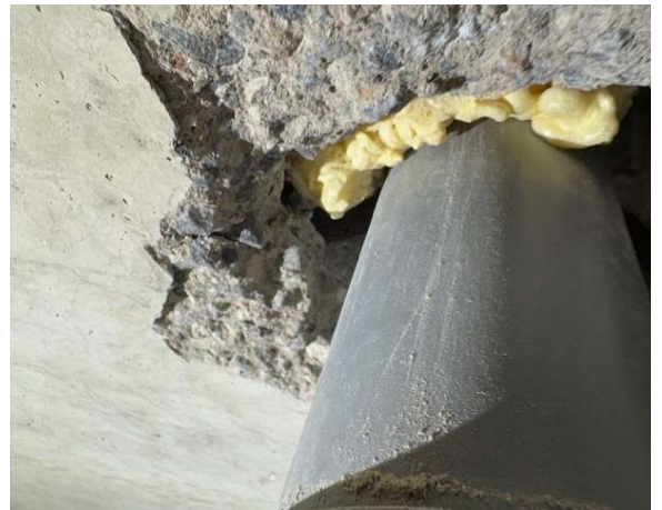
Kuva 44 Läpiviennit ovat epätiivitä.
