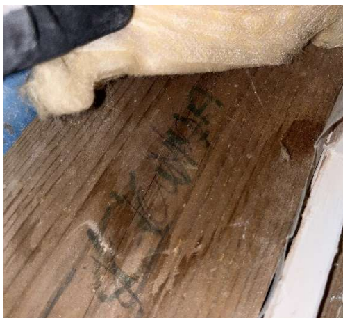
Kuva 75 Rakenneavaus US6. Puun pinnalla havaittiin lieviä kosteusjälkiä.
