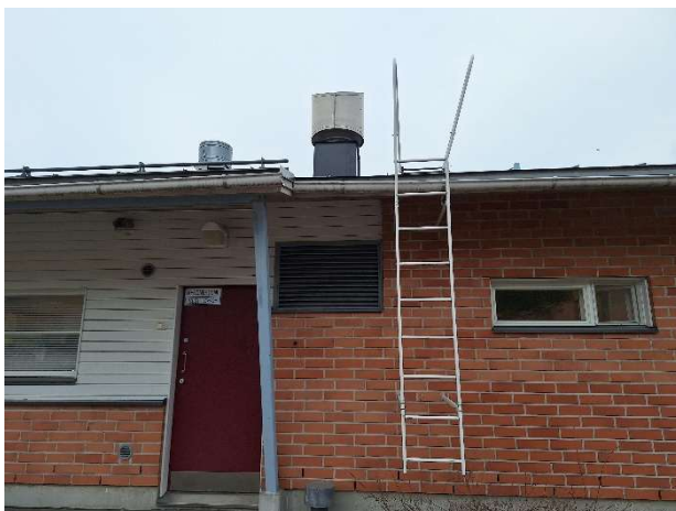
Kuva 107. Seinätikkaiden yläpää on vääntynyt lumen voimasta.
