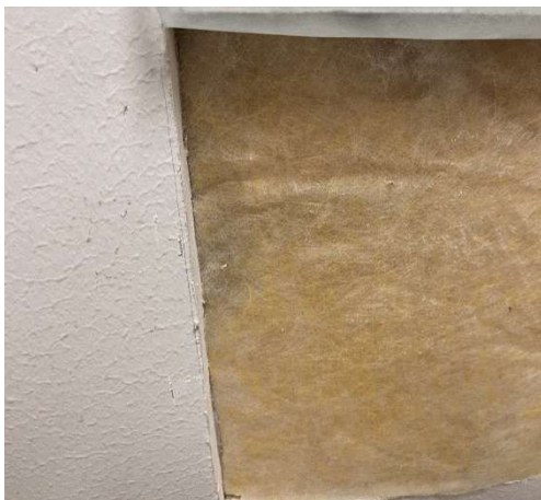
Kuva 79 Rakenneavaus US7. Villan sisäpinnassa havaittiin tummumaa. Villasta otetussa materiaalinäytteessä N19 ei havaittu mikrobikasvua.
