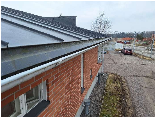
Kuva 105. Tippapelti ohjaa sadeveden paikoin sadevesikourun ohi.
