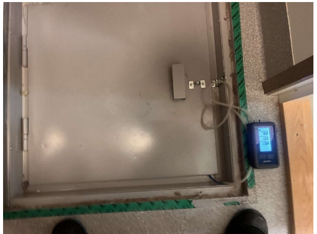
Kuva 115 Hetkellinen paine-ero sisäilman ja ryömintätilan suhteen oli n. 5-7 Pa alipainetta tilassa 27.
