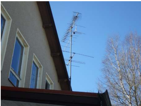
84. Vastaanottoantenni rakennuksen katolla.
