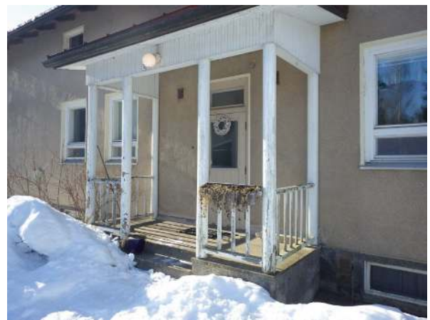
62. Päälle unohtunut ulkovalaisin.
