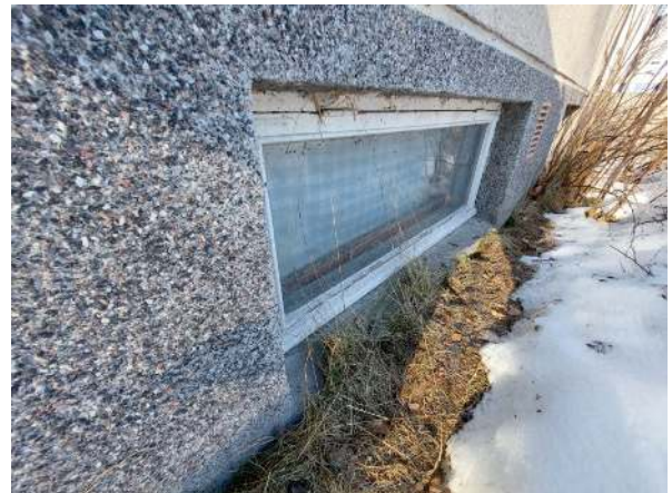
12. Kellarin ikkunat ovat huonossa kunnossa.
