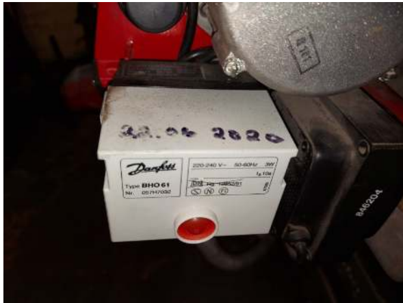
40. Säätolaitteet on uusittu vuonna 22.6.2020.
