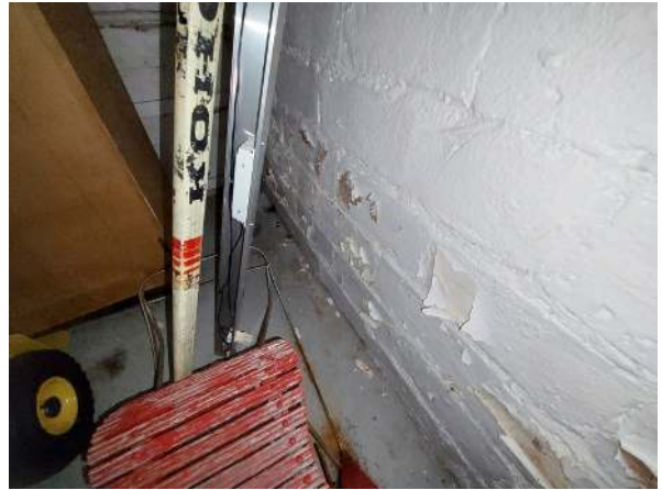
26. Kosteusrasituksesta johtuvaa hilseilyä kellarin seinissä.
