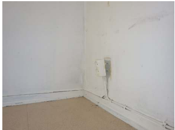
74. Huoneiston seinästä irronnut maadoittamaton pistorasia.
