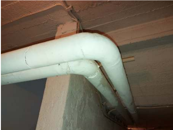
43. Mahdollisesti asbestia sisältäviä eristeitä.
