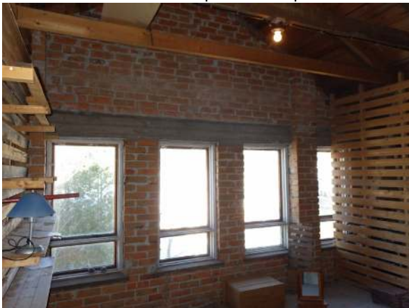
79. Ullakon valaisin, josta puuttuu kupu.
