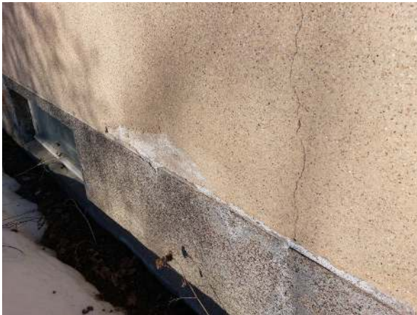
9. Rappauksessa hilseilyä ja halkeilua
