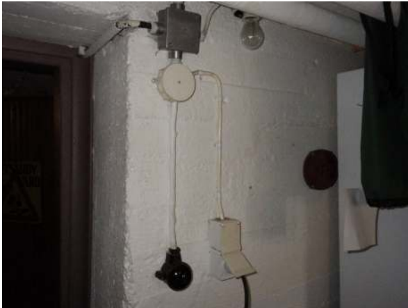
77. Kellarin valaisimesta puuttuu kupu.
