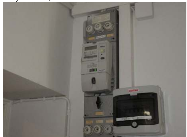
68. Huoneiston ryhmäkeskus, johon on jälkepäin lisätty vikavirtasuojakytkimet.
