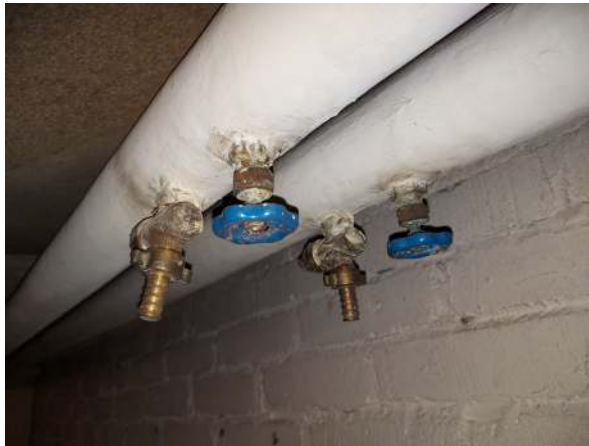
39. Linjasäätö- ja sulkuventtiilit.
