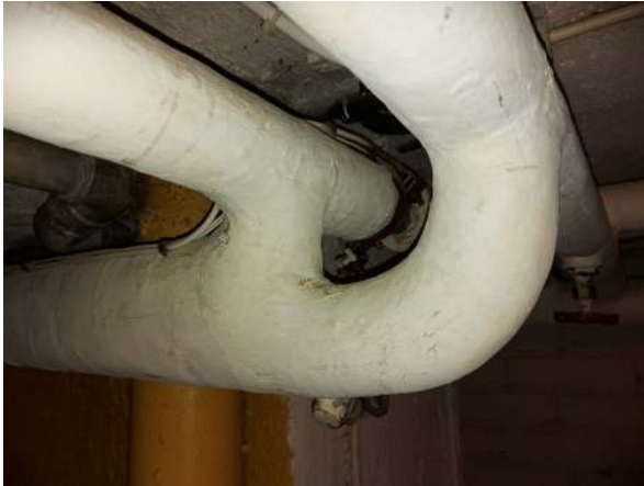
54. Putkieristeet saattavat sisältää asbestia.
