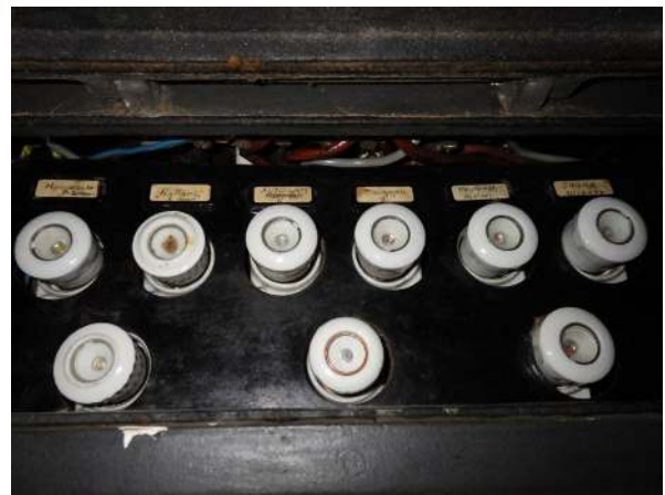
66. Kiinteistökeskuksessa kosketusjännitepuutteita (johdot ja liittimet suojaamatta).
