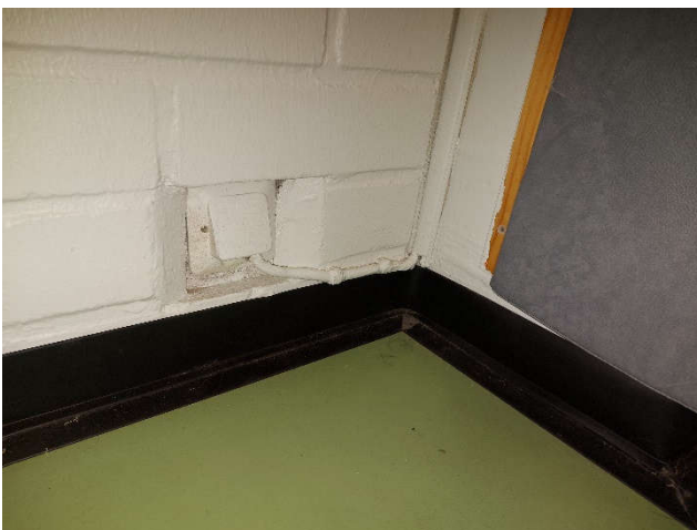
Kuva 5. Ilmavuotoa havaittiin sähköläpivientien kautta.
