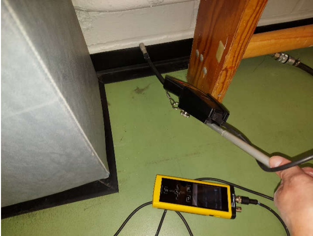
Kuva 7. Ilmavuotoa havaittiin ulkoseinä-lattialiittymän kautta yksittäisestä kohdasta.
