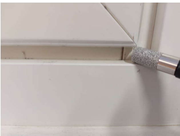
Kuva 11. Ilmavuotoa havaittiin ikkunan karmiliitosten kautta.
