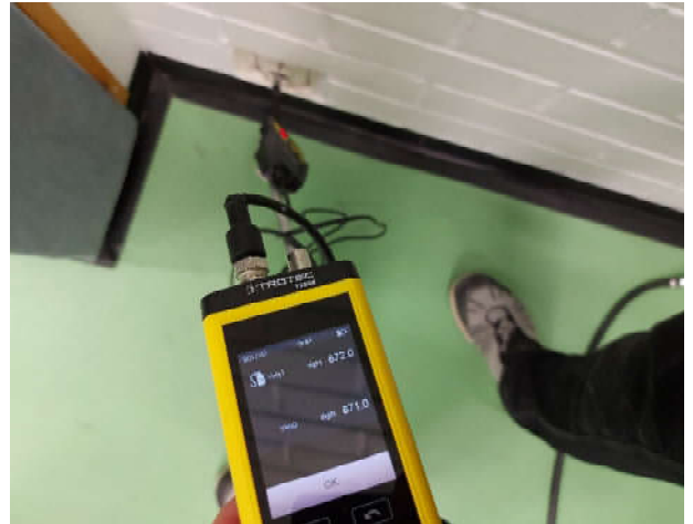
Kuva 4. Ilmavuotoa havaittiin sähköpistorasioiden kautta.
