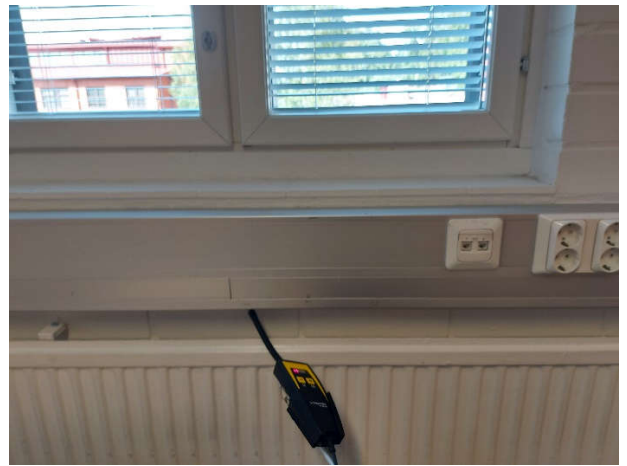
Kuva 16. Ilmavuotoa havaittiin sähkökourun kannakkeiden läpivientien kautta.
