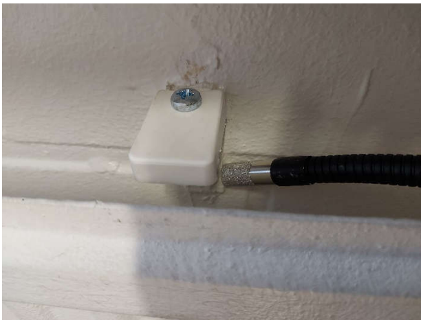
Kuva 15. Ilmavuotoa havaittiin patterikannakkeiden läpivientien kautta.
