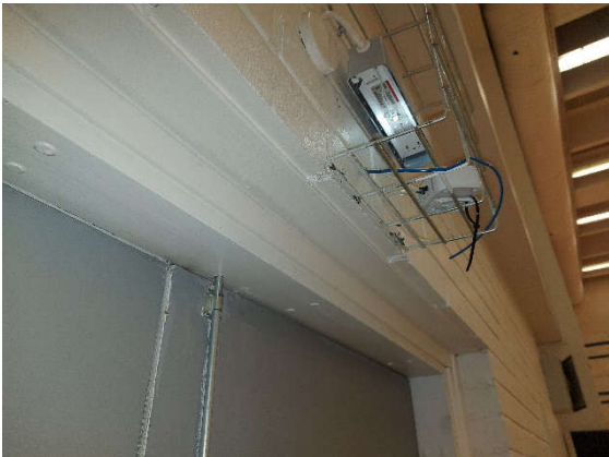
Kuva 2. Liikuntasalin paine-eromittarin letku oli irrotettu/irronnut ulko-oven välistä.
