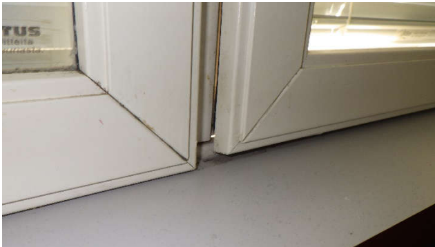
Kuva 17. Ikkunat eivät ole tiiviitä.
