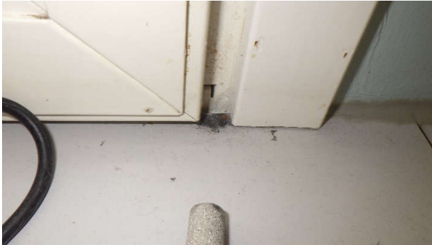
Kuva 15. Kotitalousluokissa ilmavuoto tulee todennäköisesti ikkunan karmirakenteiden kautta.
