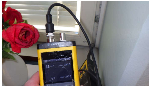
Kuva 18. Kotitalousluokissa havaittiin ilmavuotoa ikkuna-ulkoseinäliittymien kautta.
