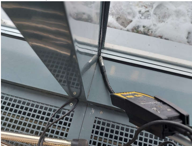
Kuva 5. Musiikin luokka. Ilmavuotoa ikkunarakenteiden kautta.
