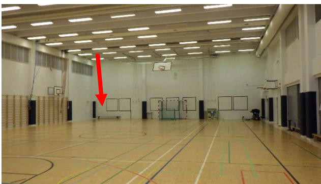
Kuva 11. Liikuntasali. Ilmavuotoa sähköpistorasian kautta sisäilmaan.
