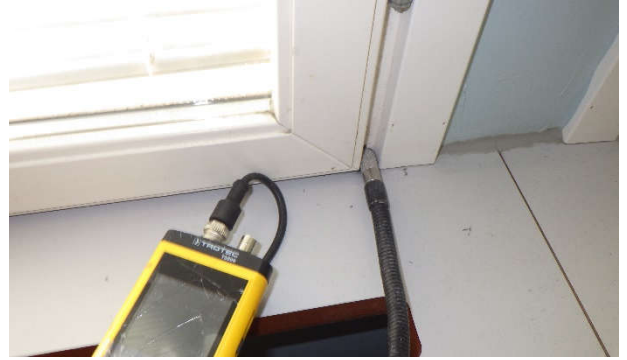
Kuva 14. Kotitalousluokissa havaittiin ilmavuotoa ikkunarakenteiden kautta.
