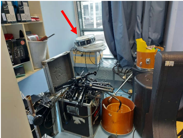
Kuva 3. Musiikin luokka. Ilmavuotoa ikkuna-ulkoseinäliittymästä.
