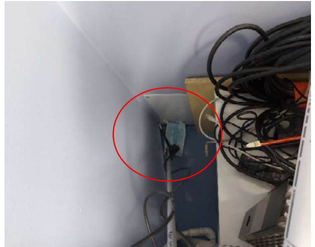
Kuva 8. Musiikin luokka, tila 55. Ilmavuotoa lattia-ulkoseinäliittymästä väliseinän alueella.
