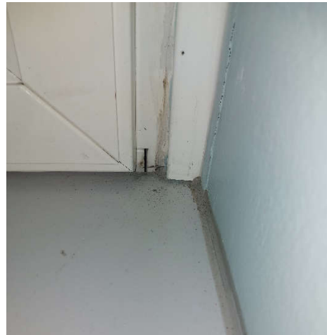
Kuva 10. Maantieto-biologian luokka (tila 21). Ilmavuoto tulee todennäköisesti ikkunan karmirakenteiden kautta.
