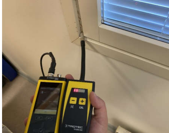
Kuva 14. Merkkiainekokeessa havaittiin ilmavuotoa mm. ikkuna-ulkoseinäliittymien ja ikkunan karmirakenteiden kautta.
