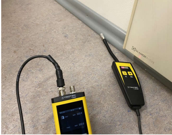
Kuva 13. Merkkiainekokeessa havaittiin ilmavuotoa mm. lattia-ulkoseinäliittymän kautta.
