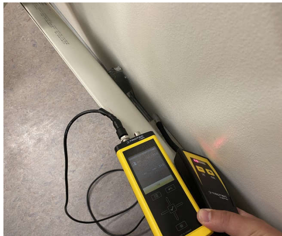
Kuva 12. Merkkiainekokeessa havaittiin ilmavuotoa mm. patterikannakkeiden kautta.
