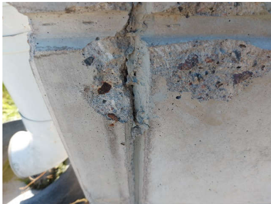
Kuva 16. Ulkoseinässä havaittiin vaurioita ja samoissa epätiiviyksiä.
