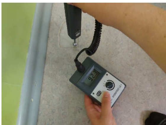
Kuva 4. Pintakosteuskartoituksessa havaittiin lievästi poikkeavia arvoja betonilattian pinnalta. Lepohuone.
