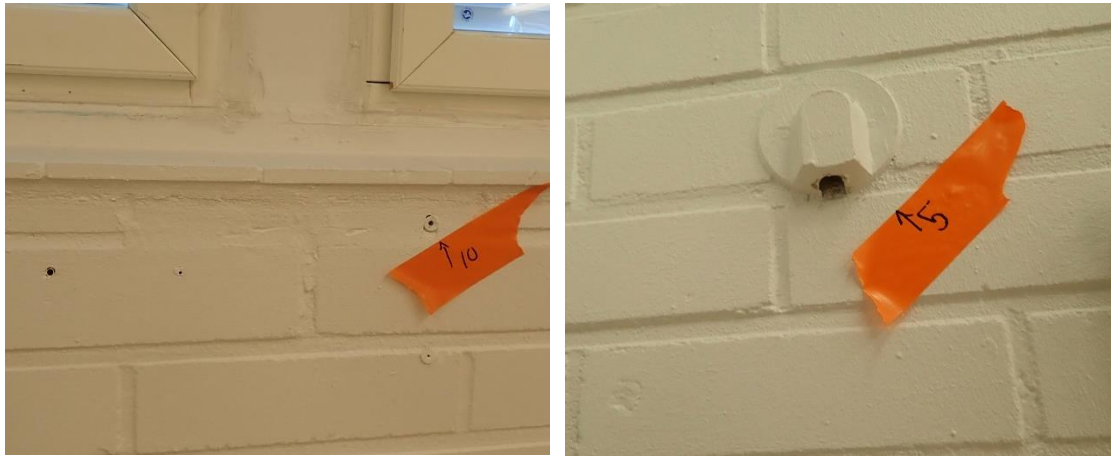
Kuva 10 a ja b. Merkkiainekokeen MA3 havaintoja. Edeltävässä kuvassa esitetyt ruuvireiän ja sähköjohdon läpiviennit vuotokohdat. Kuvassa a näkyy myös muita tiivistämättömiä ruuvireikiä, joiden kohdalla ei kuitenkaan havaittu vuotoa. Ruuvireiän kohdalla havaittiin vähäistä vuotoa ja läpiviennin kohdalla merkittävää vuotoa.
