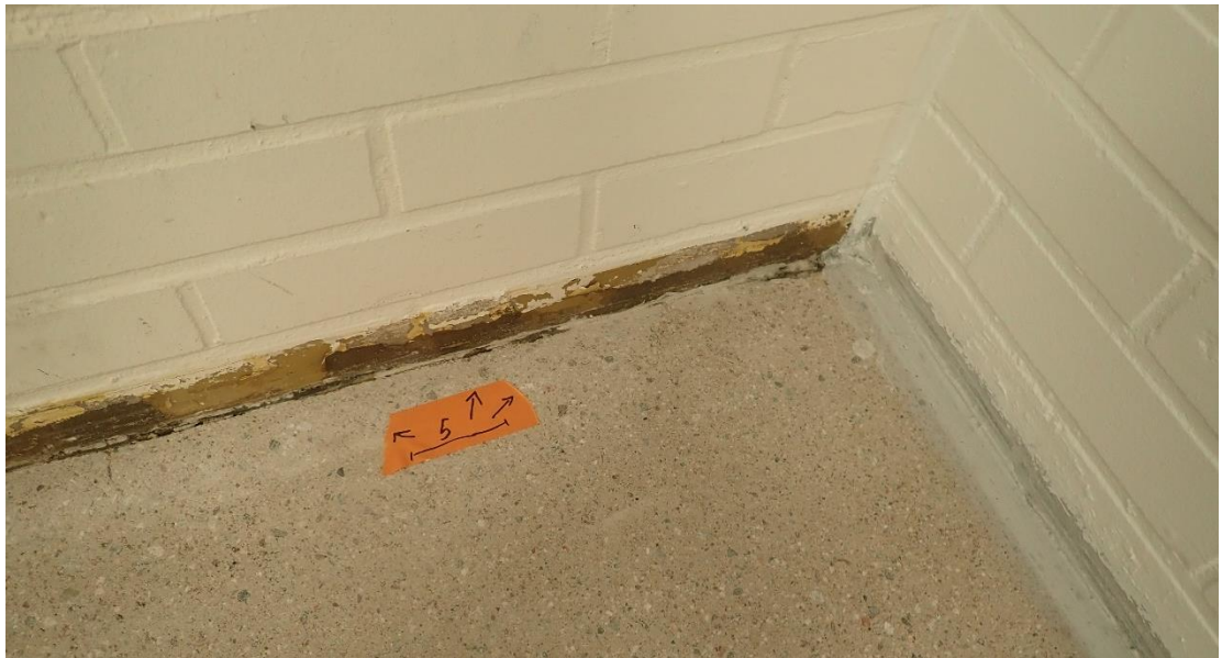
Kuva 11. Merkkiainekokeessa MA3 havaittiin merkittävää vuotoa alapohja-väliseinäliittymän kohdalta. Liittymäkohdassa oli silmämääräisesti havaittavissa rako pintabetonilaatan ja väliseinämuurauksen välissä.
