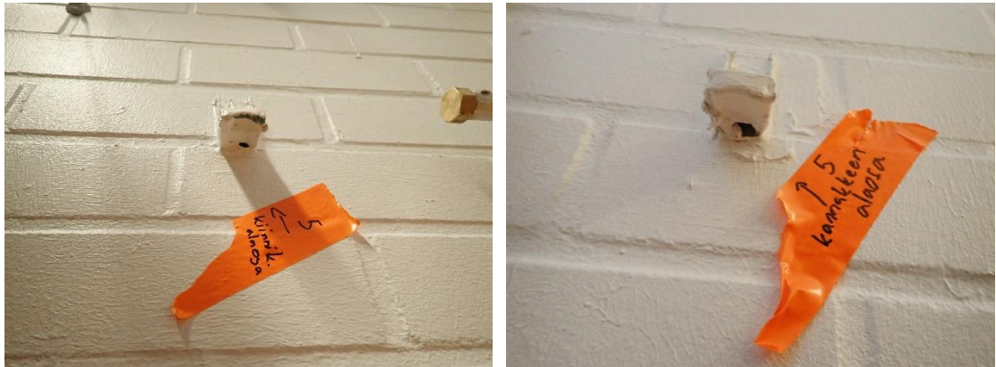
Kuva 8 a ja b. Esimerkkejä patterikannakkeiden alareunan vuotokohdista. Kannakkeen alareunan tiivistys on jäänyt selvästi vajaaksi. Esimerkin mukaisissa kohdissa vuoto oli merkittävää.
