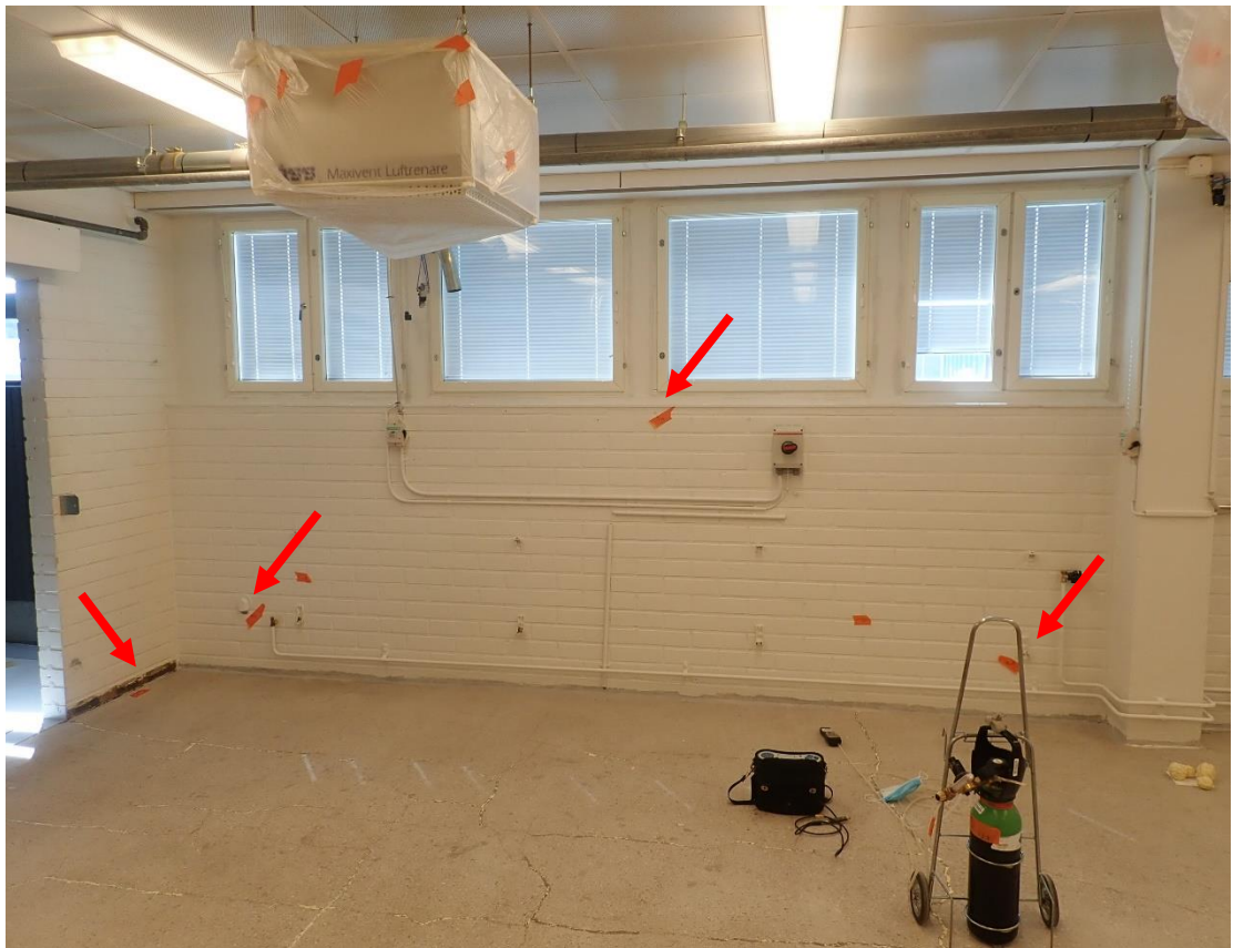
Kuva 9. Merkkiainekeemittauksen MA3 havaintoja. Vuotoa havaittiin punaisella nuolella merkityissä kohdissa; patterikannakkeen alareuna, ruuvireikä, sähköjohtoläpiviennit kohta sekä väliseinä-alapohjaliittymä. Muilta osin ei havaittu vuotoja. Merkkiainekeemittauksen syöttöpisteet on merkitty oranssilla teipillä keemittauksen jälkeen.
