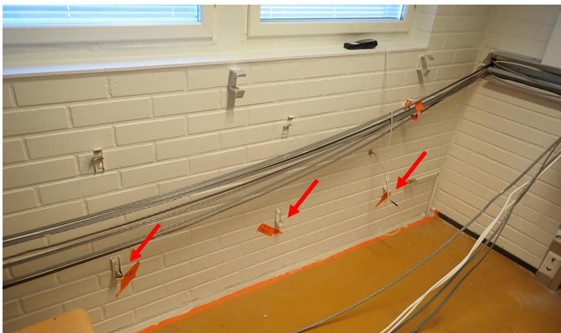
Kuva 7. Merkkiaineokeen MA1 havaintoja. Punaisella nuolella merkittyjen patterikannakkeiden alareunassa havaittiin vaihdellen vähäistä ja merkittävää ilmavuotoa. Kuvan ulkopuolelle jäävissä patterikannakkeissa havaittiin vastaavia vuotokohtia. Muilta osin kokeessa MA1 ei havaittu vuotoja.
