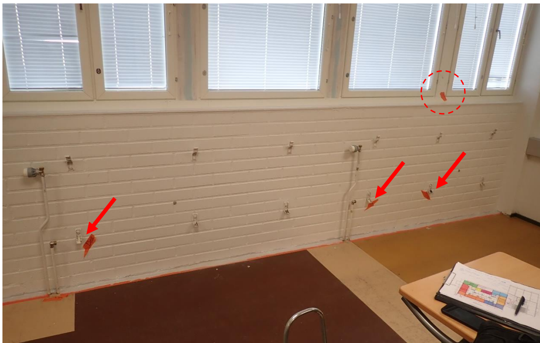
Kuva 6. Merkkiaineokeen MA2 havaintoja. Punaisella nuolella merkittyjen patterikannakkeiden alareunassa havaittiin vaihdellen vähäistä ja merkittävää ilmavuotoa. Lisäksi vähäistä ilmavuotoa havaittiin kuvaan merkityn ikkunakarmin nurkassa olevan sormiliitoksen kohdalla. Muilta osin kokeessa MA2 ei havaittu vuotoja.
